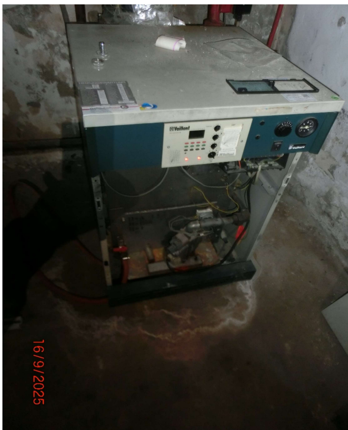
Keller und Heizzentrale
