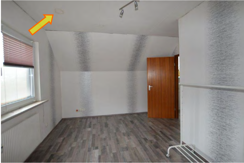
Feuchtigkeitsschäden an der Decke im Dachgeschoss
