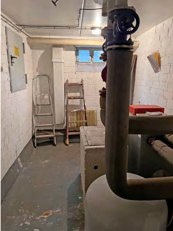
Heizungsraum mit Klappe zum Öltankraum
