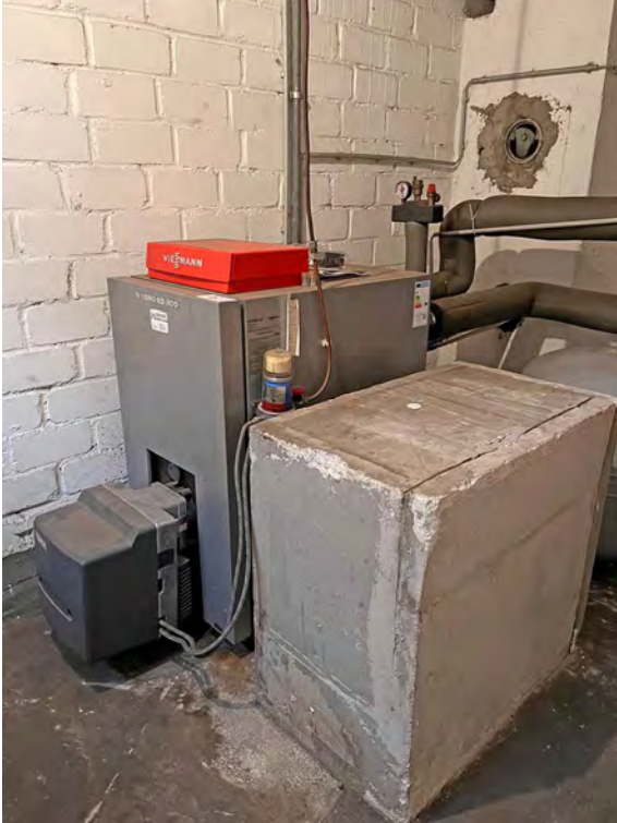
Heizungsraum mit Ölzentralheizung
