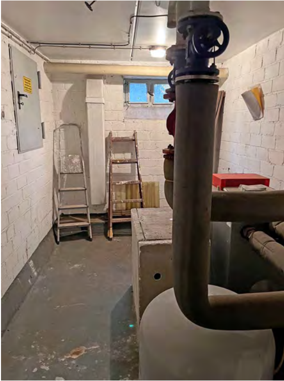
Heizungsraum mit Klappe zum Öltankraum
