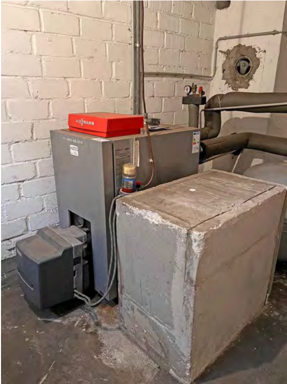
Heizungsraum mit Ölzentralheizung
