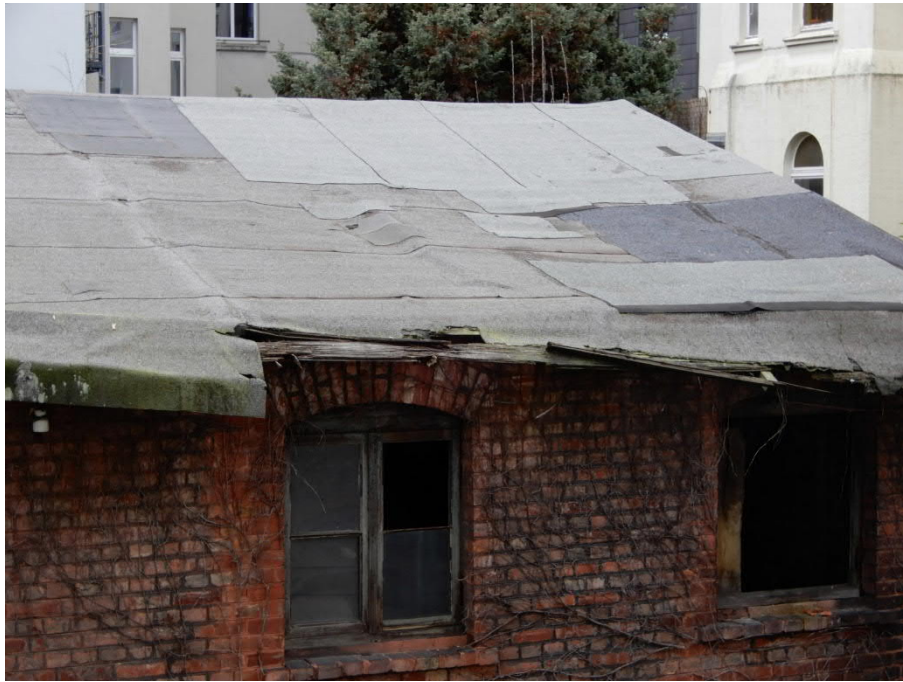
Hinterhaus Beschädigungen am Dach/fehlende Fenster
