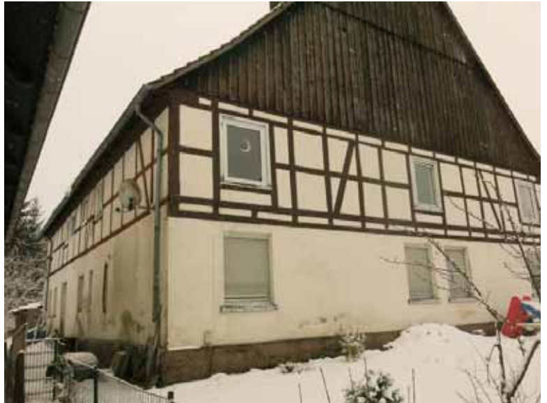
Ostseite (Feuchte-)Schäden am Putz und Fachwerk (im Hintergrund abgängige Anbauten)
