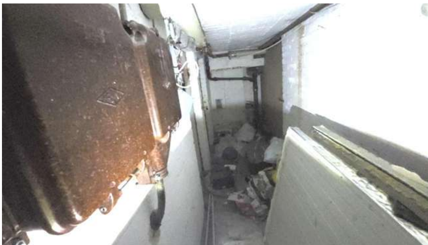
KG; Hausanschlusskästen elektr. Strom im Kellerflur; Starke Vermüllung des Kellerflures.
