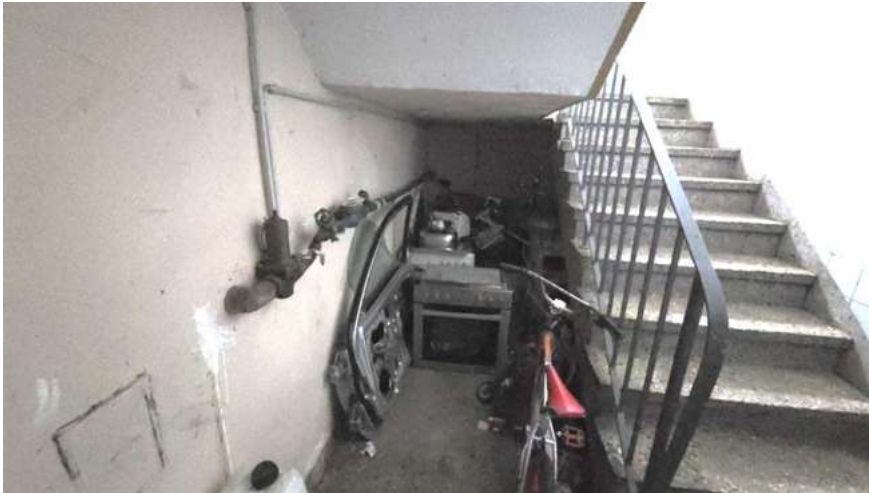
KG; Wasserabschluss; Vermüllung im Kellerflur.
