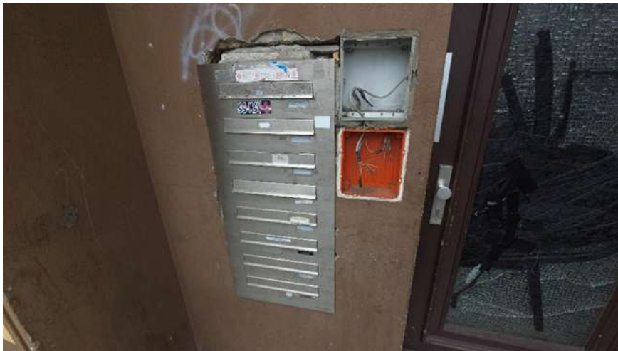
Massive Bauschäden im Hauseingangsbereich.
