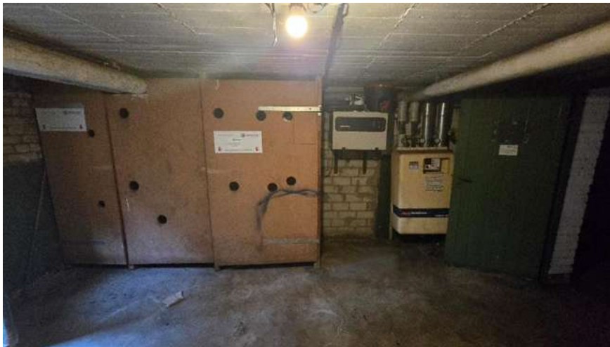
KG; Fernwärmeübergabestation im Wasch- / Trockenkellerraum. Der ehemalige Zugang zu einem Kellerraum zu SE 3 wurde dauerhaft verschlossen (Mauerwerk neben der Übergabestation).
