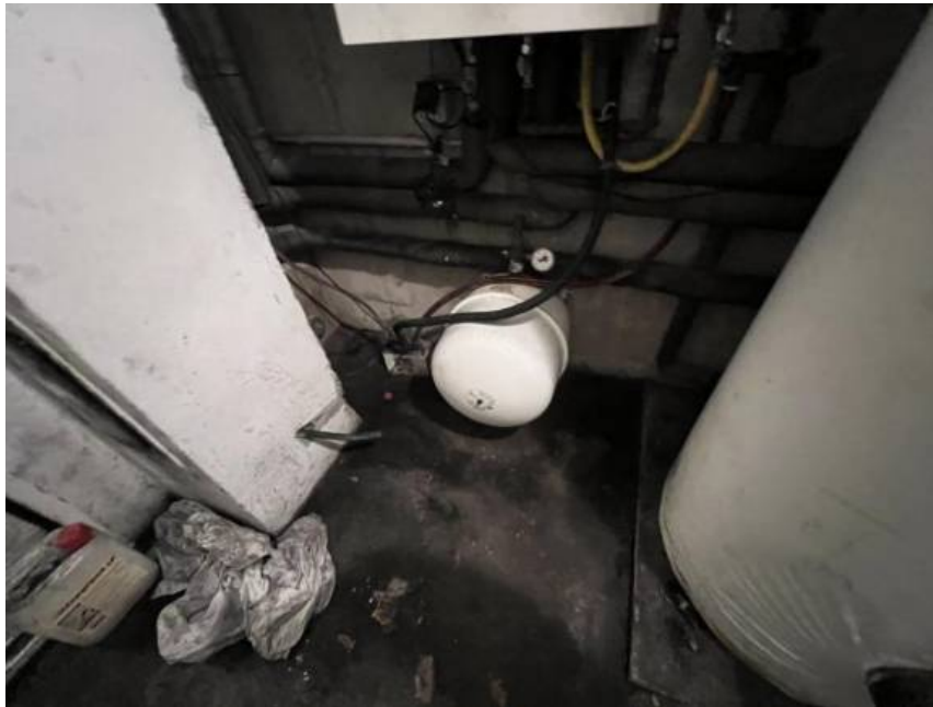
Feuchtigkeitsschaden durch den Warmwasserspeicher
