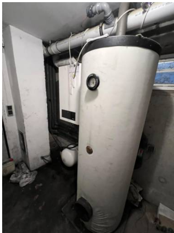
Gasheizung und Warmwasserspeicher
