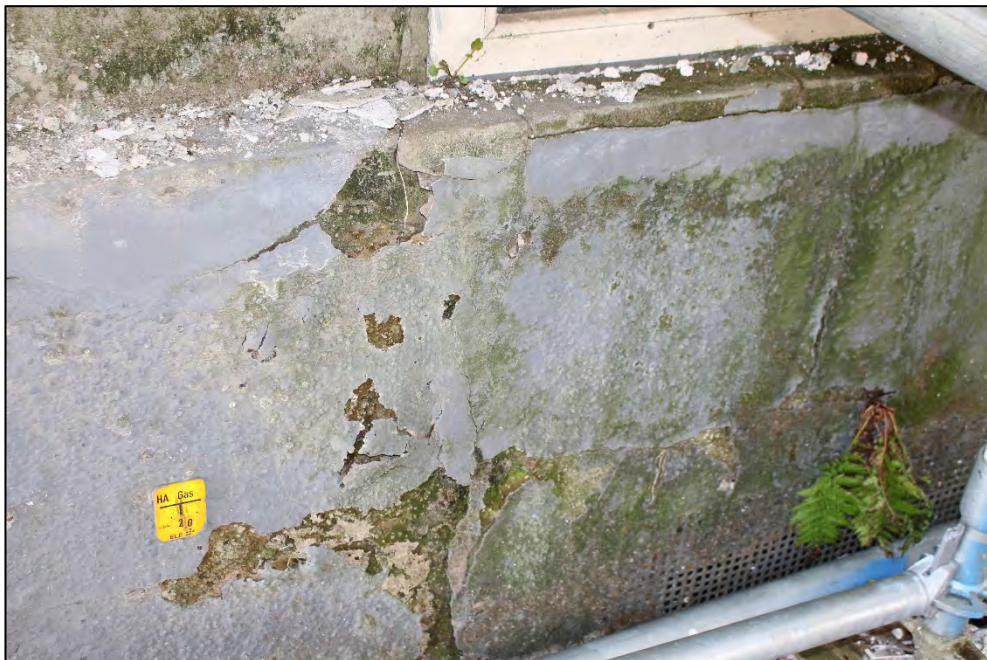
Foto Nr. 10: Straßenfassade / Sockelputz
