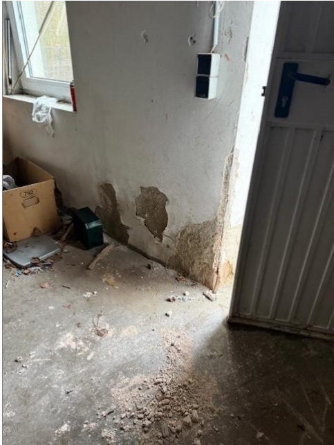
Bild 21: feuchte Wand Garage
