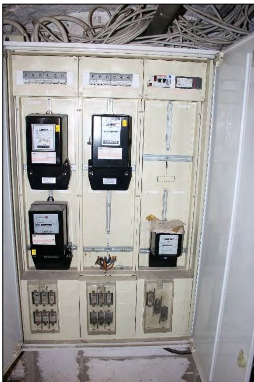
Foto Nr. 12: Kellergeschoss, Elektrounterverteilung
