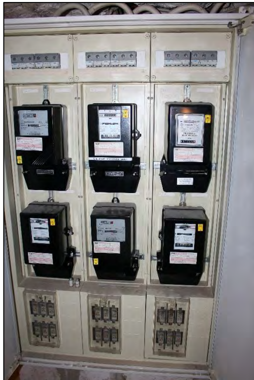
Foto Nr. 13: Kellergeschoss, Elektrounterverteilung
