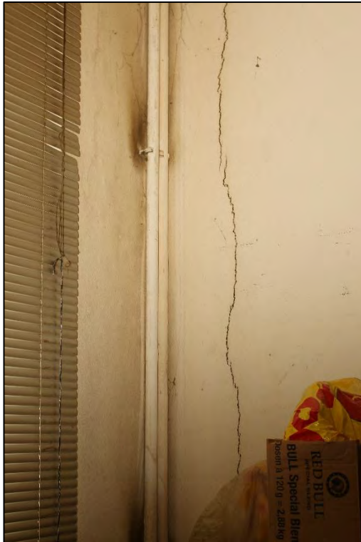
Foto Nr. 37: ETW Nr. 2, Erdgeschoss, Schlafzimmer, Wandriss
