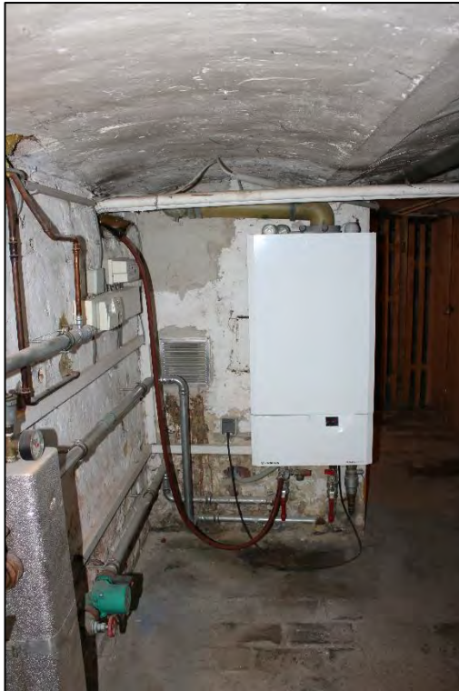
Foto Nr. 21: Kellergeschoss, Heizungskeller
