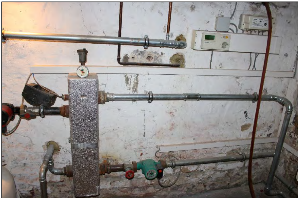
Foto Nr. 22: Kellergeschoss, Heizungskeller
