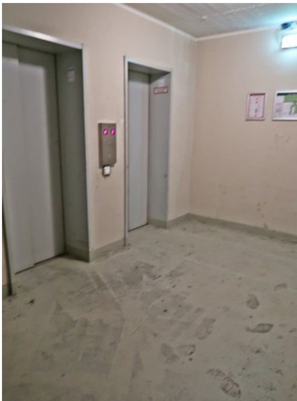
Vorraum Personenaufzüge Haus B
