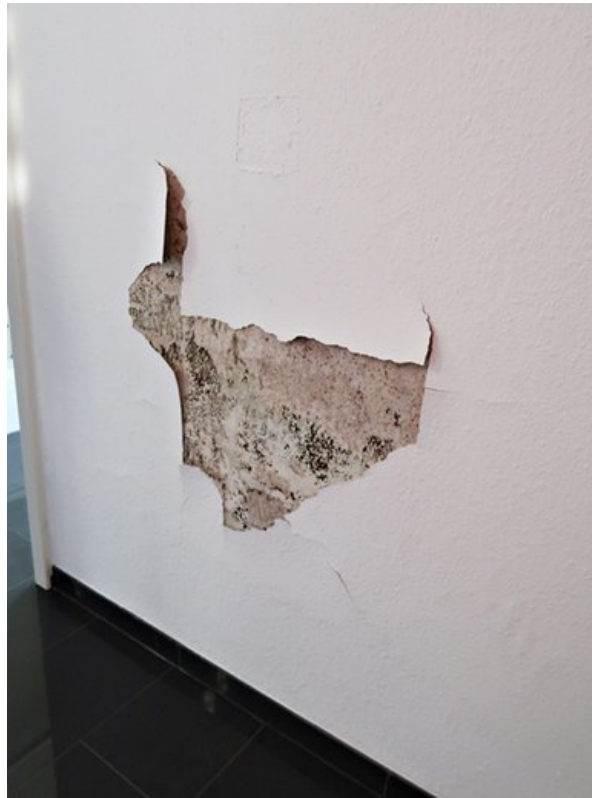
Feuchteschaden Wandfläche Flur 1
