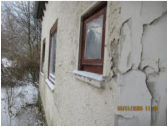
Ostfassade mit Putzschäden
