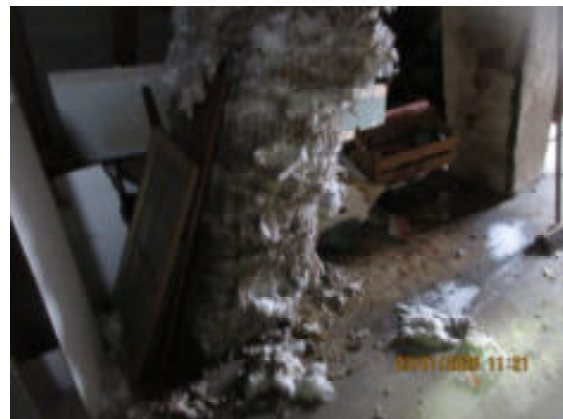
Abgängige Schornsteindämmung und Schneespuren auf dem Fußboden
