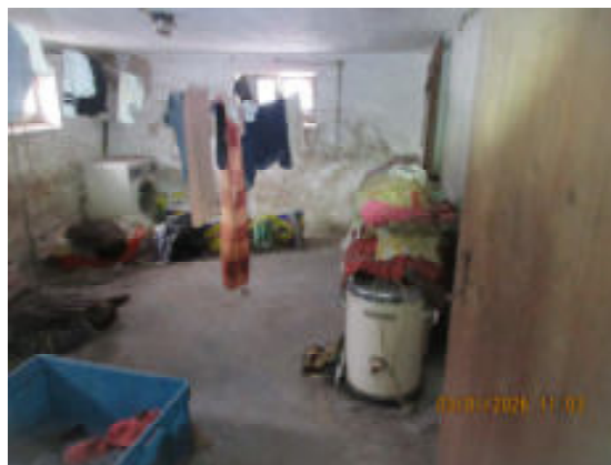
Waschkeller / großflächige Putzschäden /Feuchte
