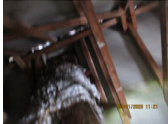
Fehlstellen in der Firstabdeckung
