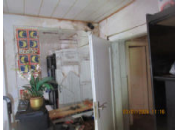
starke Feuchtespuren / im Bereich des Schornsteins
