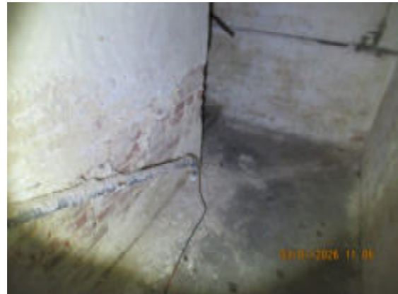
Kellerwand zum Stall / Schäden
