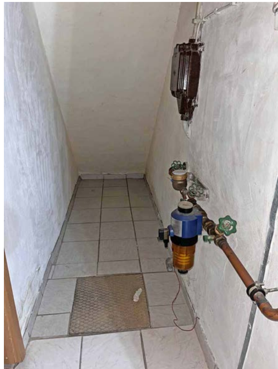
Hausanschlüsse unter der Kellertreppe
