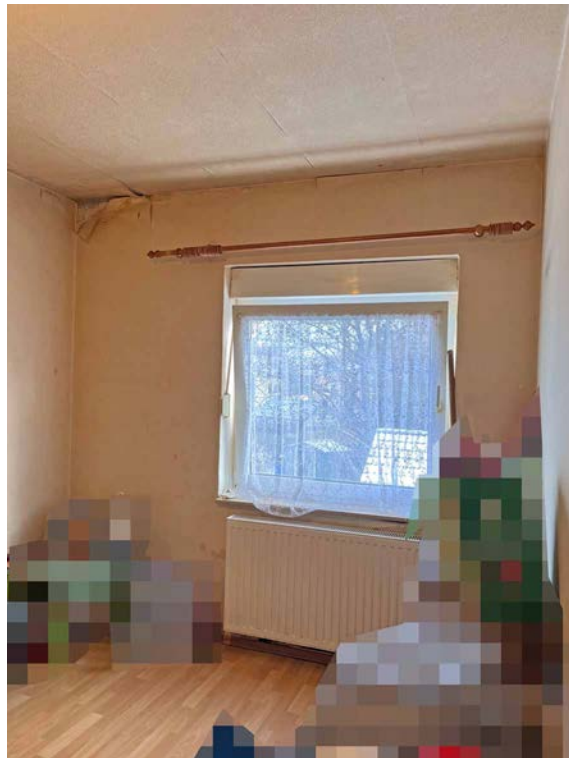
Zimmer hinten links mit Schimmelbefall
