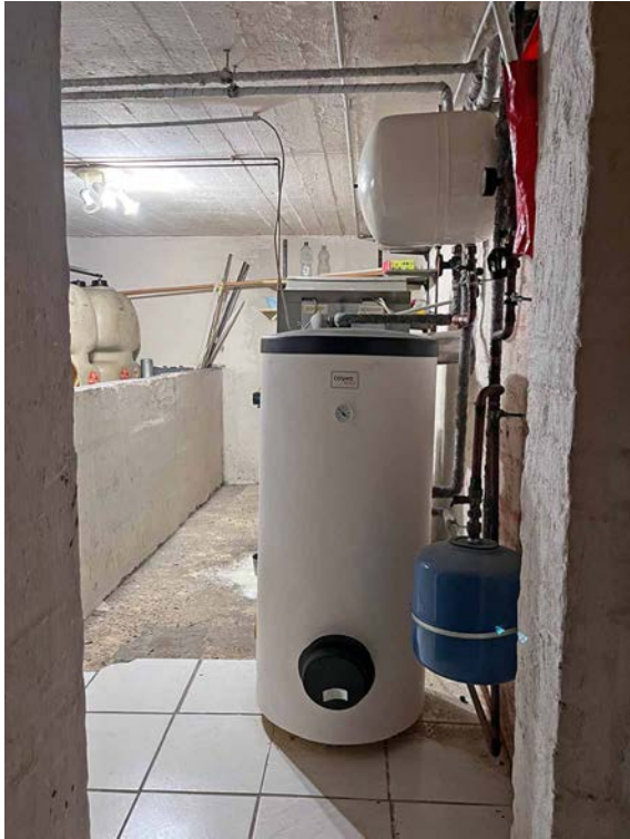
Heizungsraum mit Öltanks
