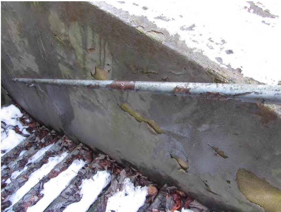
Foto 8: Wohnhaus, Kelleraußentreppe, Schäden und Feuchtigkeit im Wandbereich, korrodiertes Metallgeländer
