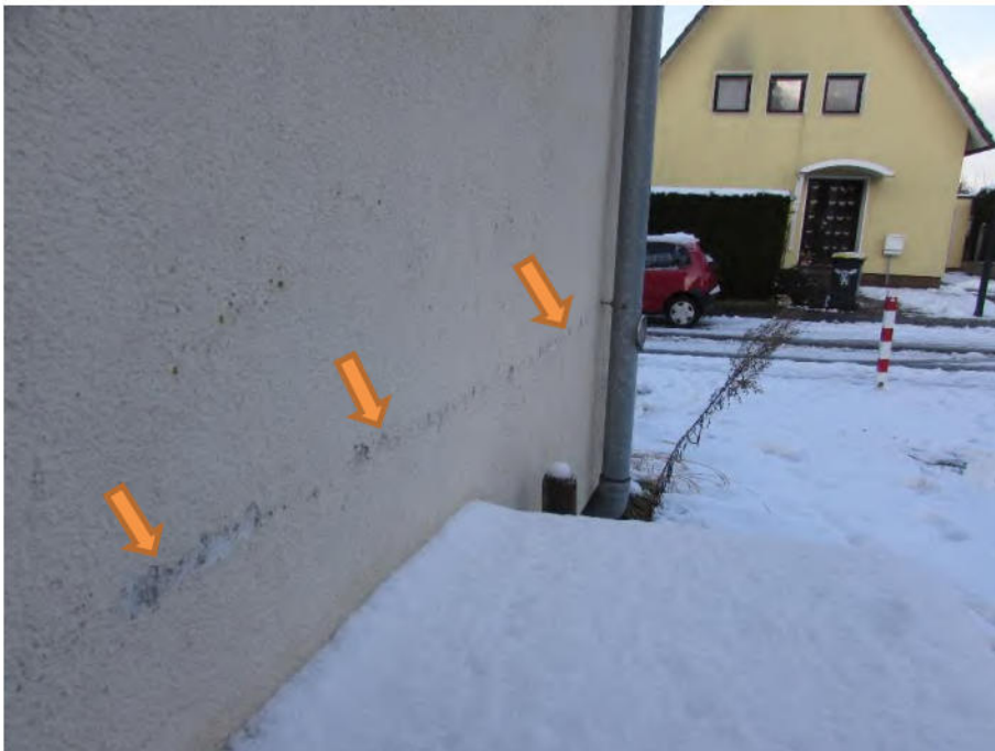
Foto 6: Wohnhaus, Putzschäden an der Fassade
