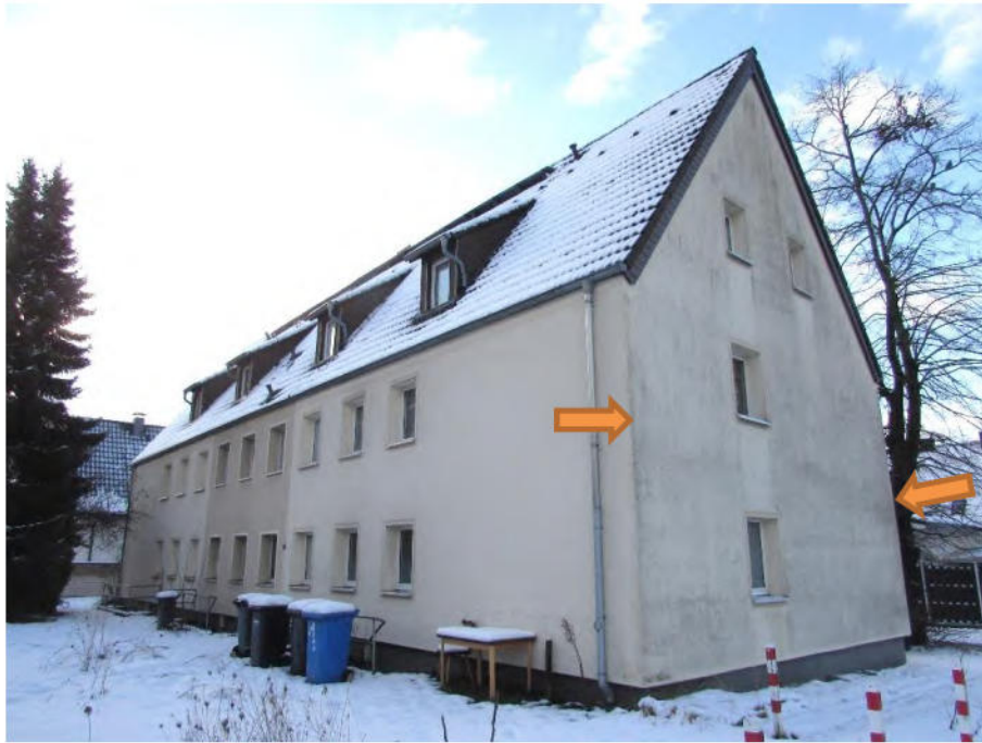
Foto 3: Wohnhaus, Rück-/Seitenansicht, fleckige Fassade
