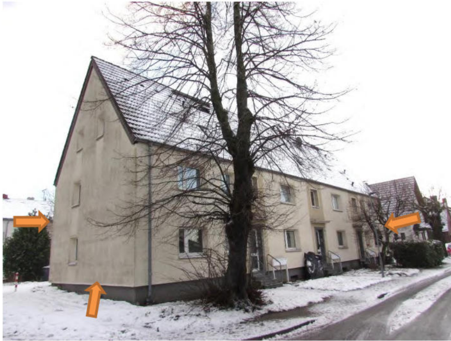
Foto 1: Flurstück 336, Wohnhaus, Straßen-/Seitenansicht, fleckige Fassade
