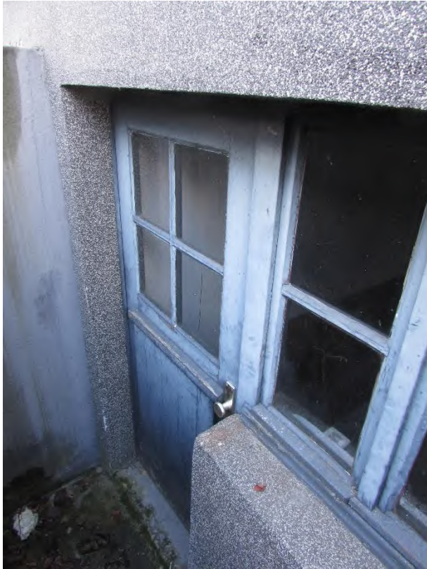
Foto 9: Wohnhaus, überalterte Kelleraußentür und Kellerfenster
