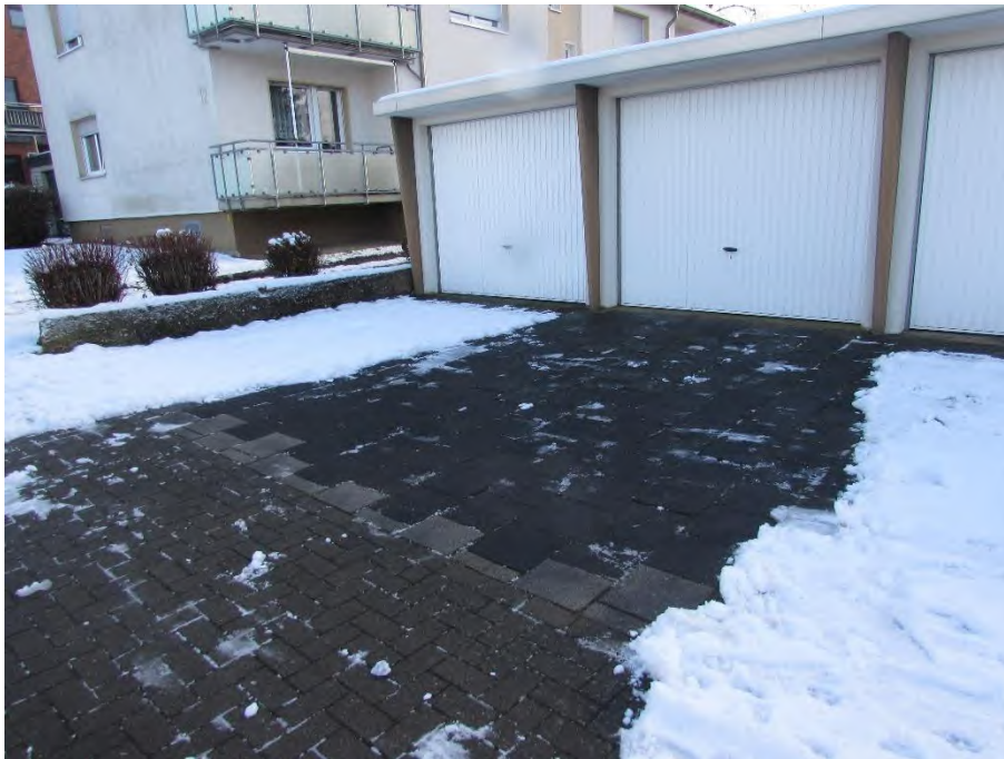
Foto 13: PKW-Reihengaragen, abgesetzte Betonplatten der Zufahrt
