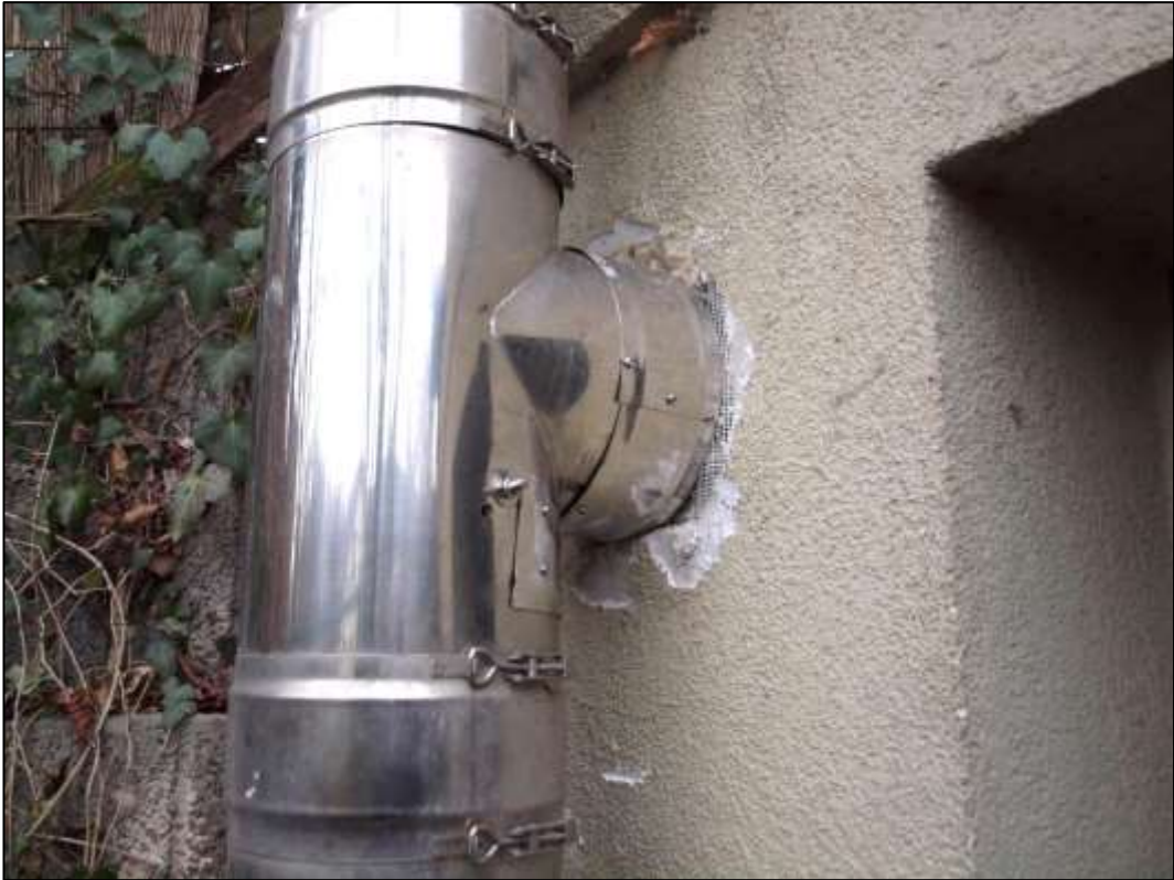
laienhaft montiertes Kaminrohr
