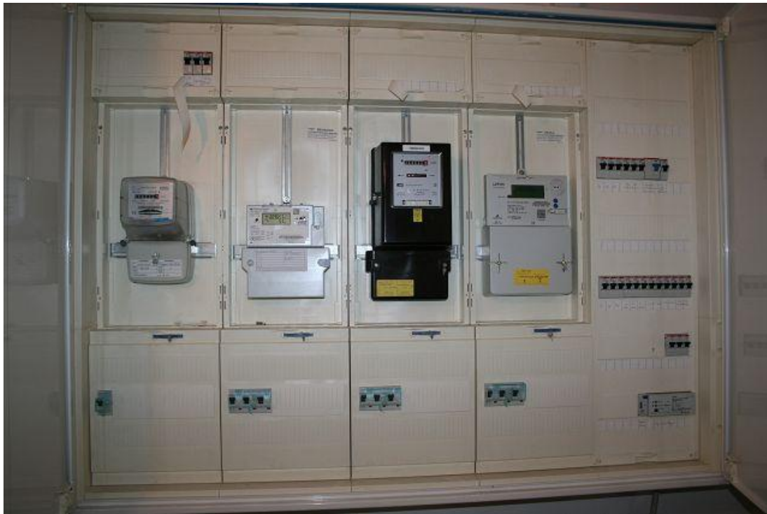
Bild 14 Elektroverteilung im Keller.
