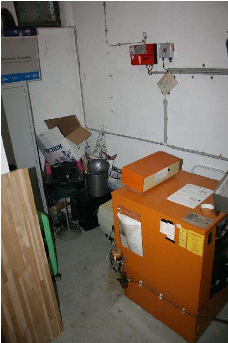
Bild 15 Die Heizungsanlage im Keller.
