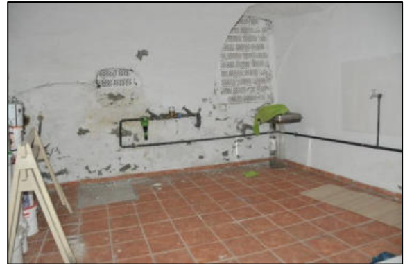
Kellerraum mit Hausanschluss Wasser
