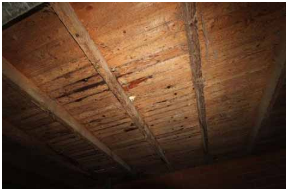
Sicht auf die Feuchtigkeit in den Holzbalken des Strohlagers über der Boxengasse
