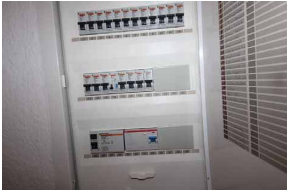
Sicht in den Sicherungskasten / DG
