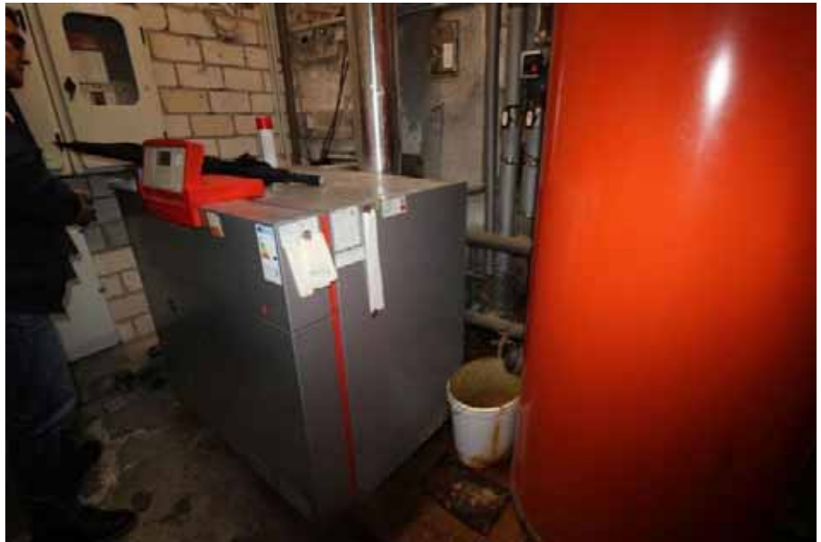
Sicht in den Heizungsraum / EG
