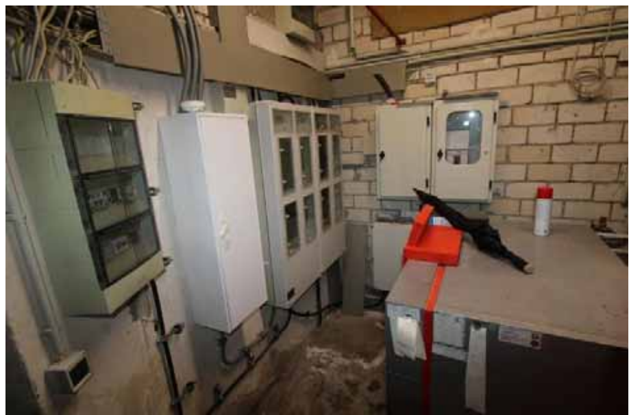
Sicht in den Heizungsraum / EG
