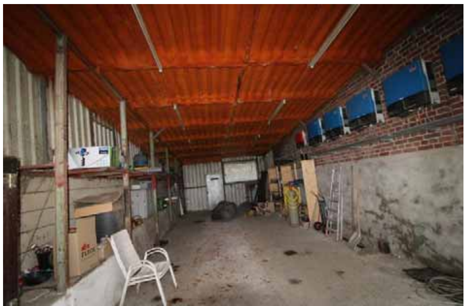
Sicht in das Lager mit weiterer Photovolta- iktechnik
