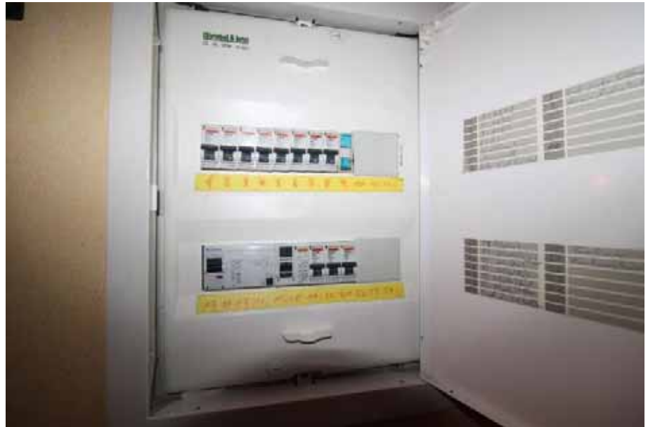
Sicht in den Sicherungskasten / EG
