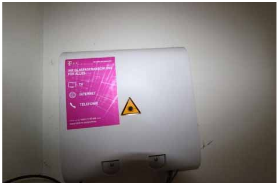
Sicht auf den Glasfaseranschluss im Treppenhausflur / EG
