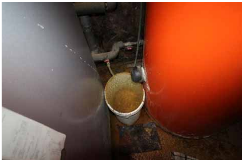
Sicht in den Heizungsraum / EG
