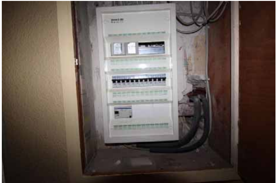
Sicht in den Sicherungskasten / OG
