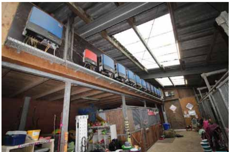
Sicht auf die Photovoltaiktechnik in der Boxengasse
