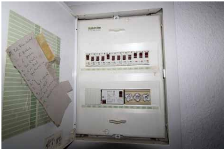
Sicht in den Sicherungskasten / OG
