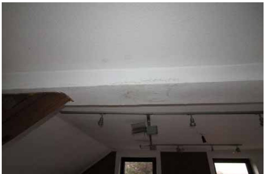
Sicht auf die Feuchtig- keit im Deckenbereich des Wohnraums / DG
