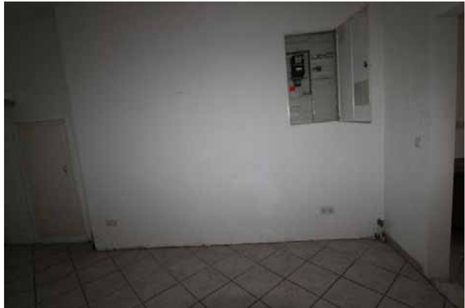
Sicht in den Raum 6 mit Sicherungs- und Zählerkasten / EG
