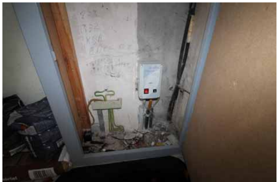
Sicht in den Anschlusskasten im Treppenhausflur / EG
