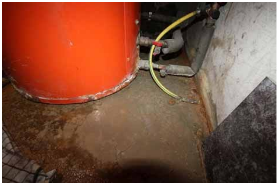
Sicht in den Heizungsraum / EG
