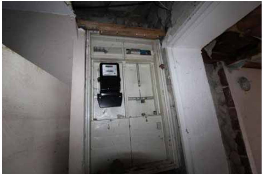
Sicht in einen Zählerkasten / EG
