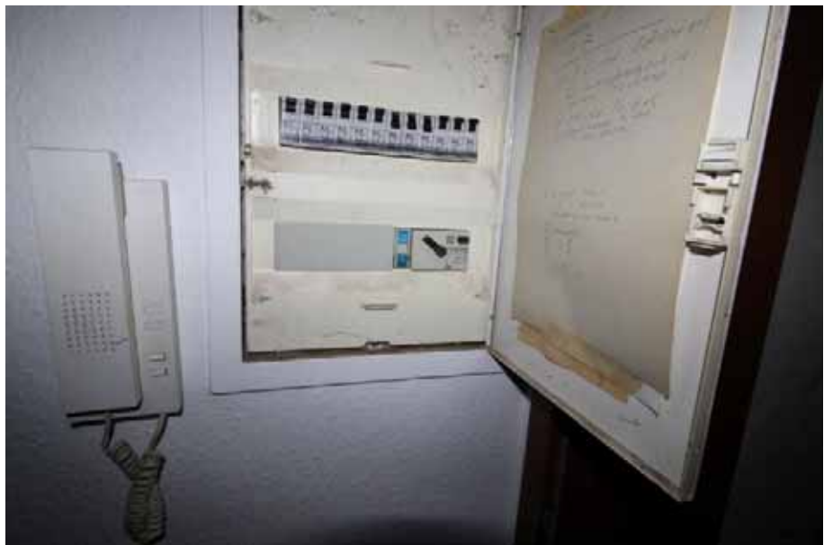
Sicht in den Siche- rungskasten im Flur / DG
