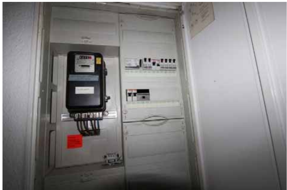
Sicht in Sicherungs- und Zählerkasten / EG
