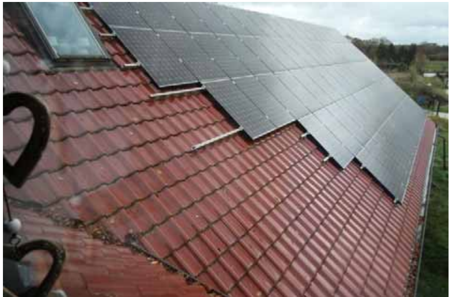
Sicht auf die Photovol- taikanlage auf dem Dach des Anbaus des Hauses Schorfheide 12
