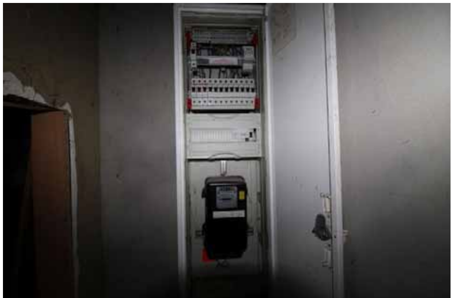
Sicht in einen Sicherungs- und Zählerkasten / EG
