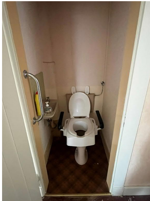
Toilette (Aufnahme eines Miteigentümers vom 21.02.2025, mit freundlicher Genehmigung)
