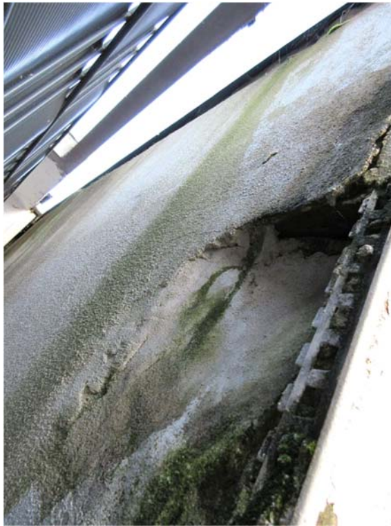
Garage Seitenwand (schadhaft)
