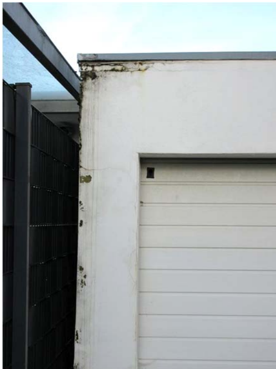
schadhafter Bereich Garage
