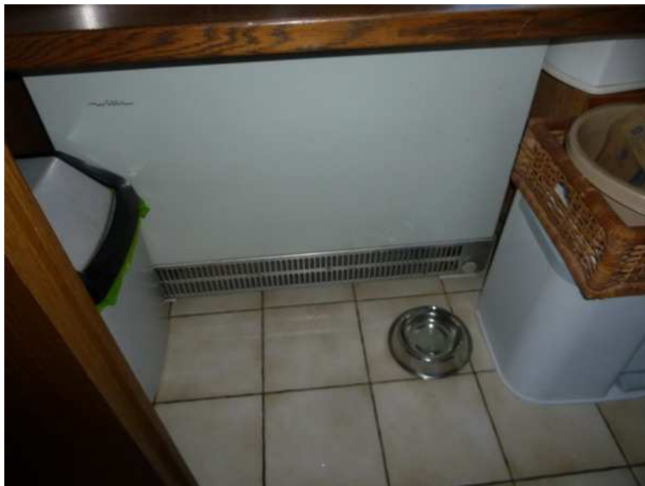
Elektroheizung in der Küche
