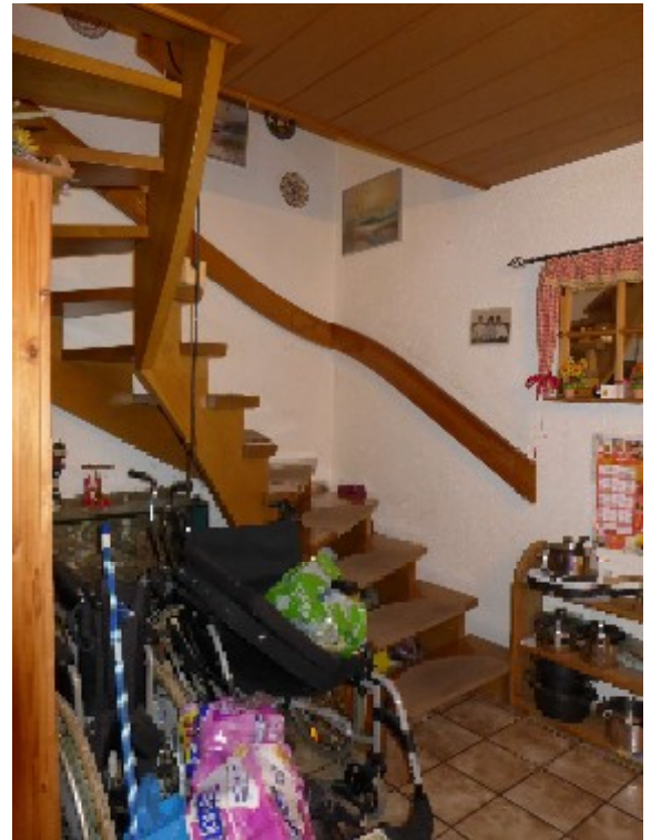
Treppe vom Erd- zum Obergeschoss in der Essdiele mit fehlender Brüstung/ Geländer an der offenen Seite
