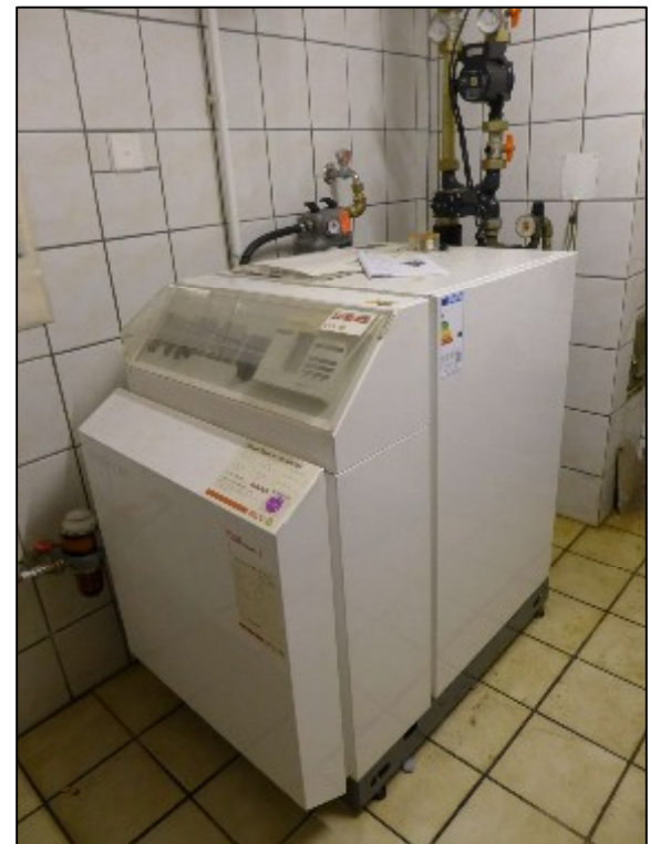
Heizung im Keller
