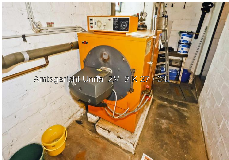
Foto Nr. 3 KG: Heizungskeller (Gemeinschaftseigentum)
