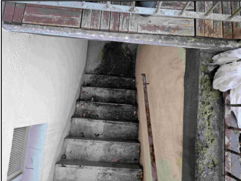
Foto 4: Kelleraußen- treppe schad- haft
