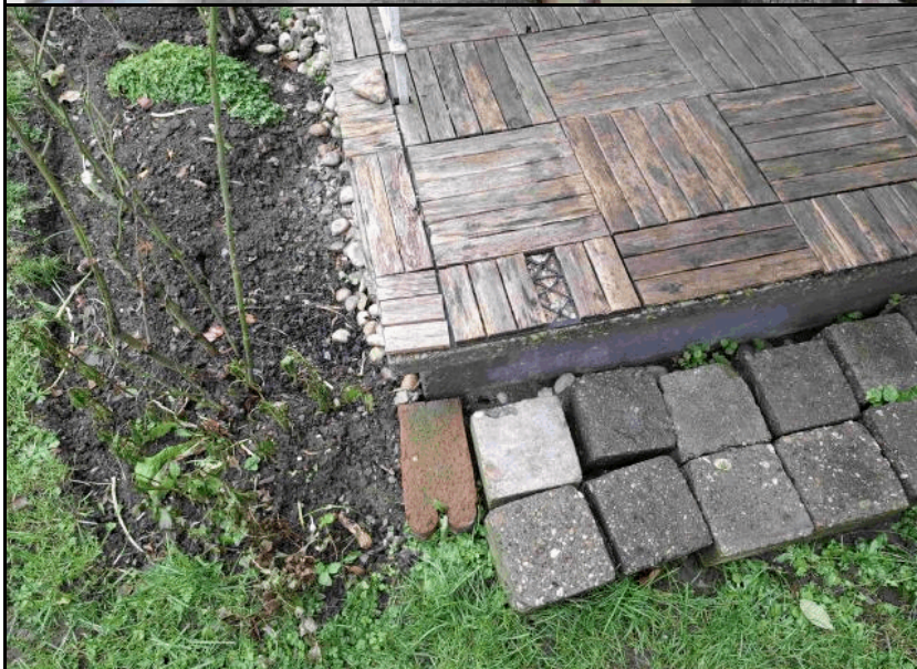
Foto 5: Terrassenbo- den schadhaft
