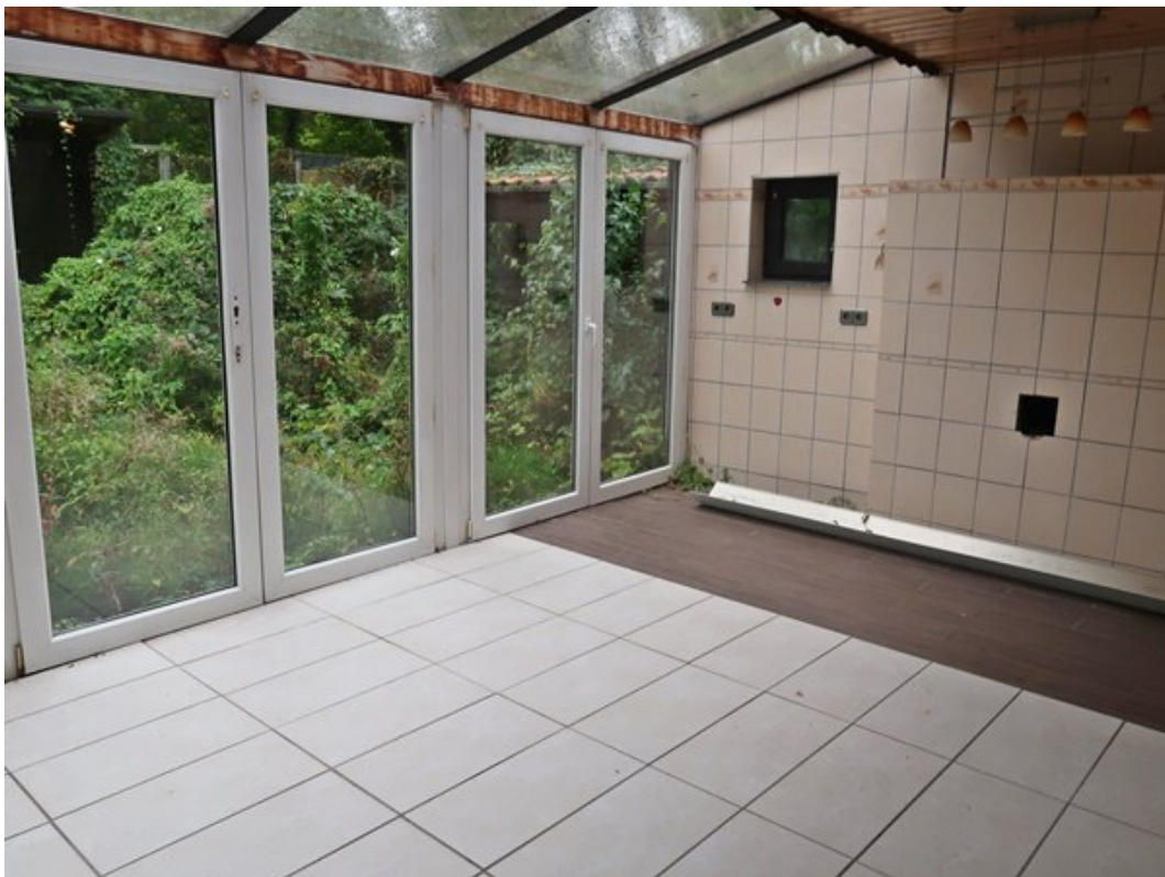
Wintergarten, bauordnungsrechtlich nicht genehmigt, mit Kaminanschluss
