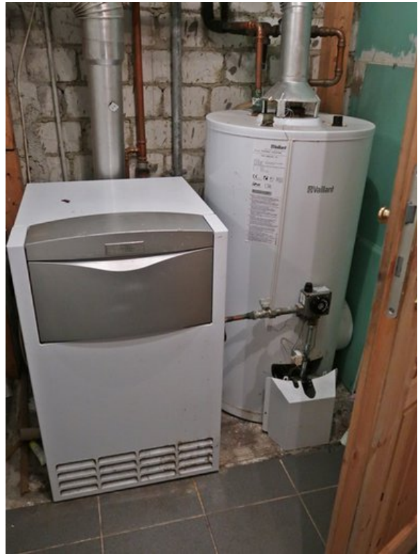
Teilansicht Kellerraum mit Gasheizkessel und Warmwasser-Standspeicher
