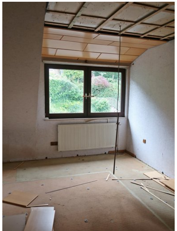
Schlafrum, Deckenbekleidung teilweise zerstört
