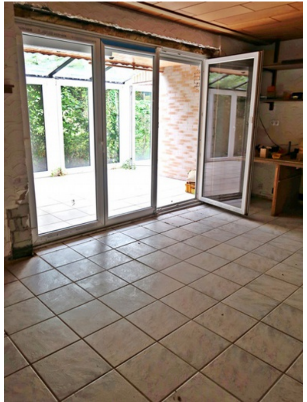
Gartenseitig gelegener Kellerraum mit Zugang zum Wintergarten, ohne Baugenehmigung errichtet
