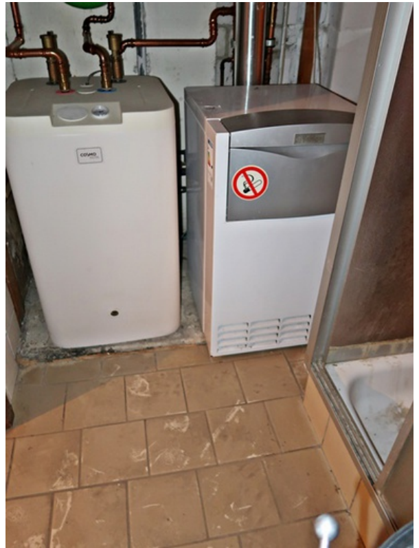
Gasheizkessel und Warmwasser-Standspeicher
