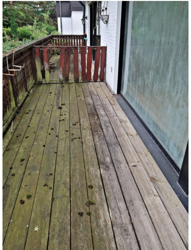
Balkon, rechts die Scheibe der Festverglasung Wohnraum, erneuerungsbedürftig
