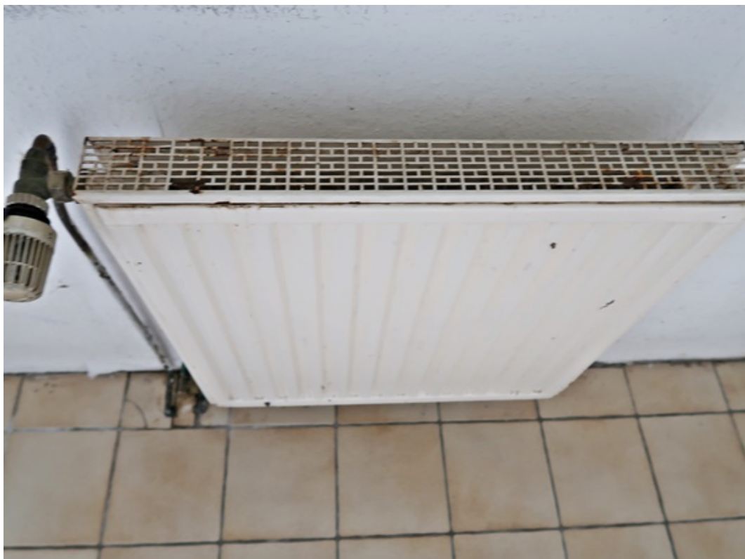
Heizkörper mit Korrosionsschäden
