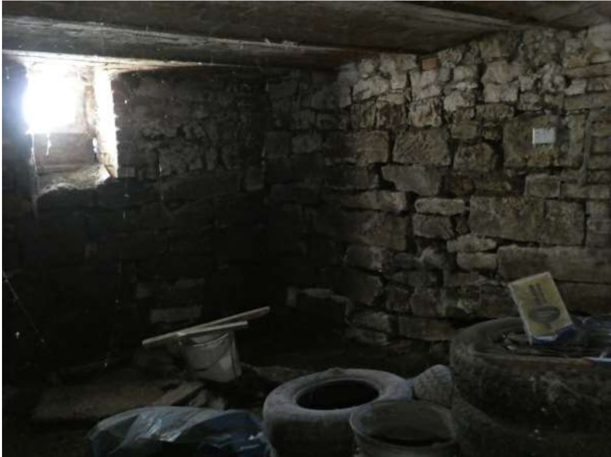
Teilunterkellerung (fehlendes Fenster in der Fensteröffnung)
