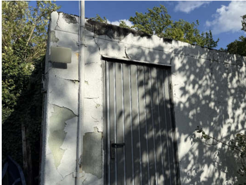
Bild 15: Farb- bzw. Putzabplatzungen an der Garage
