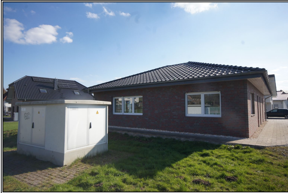
Ansicht von Nordosten (Trafo-Station im Vordergrund)
