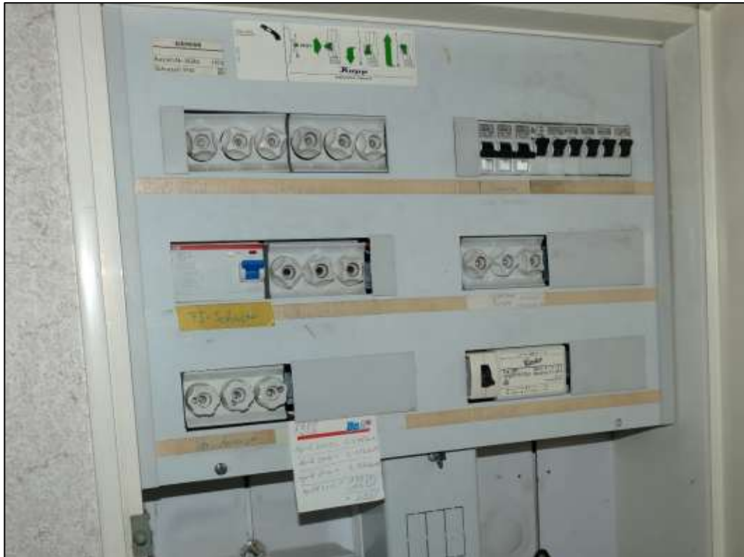
Elektro-Installation techn. überaltert
