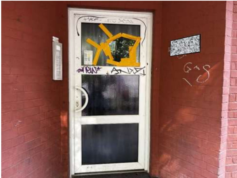
Haustür mit beschädigtem Glasfeld
