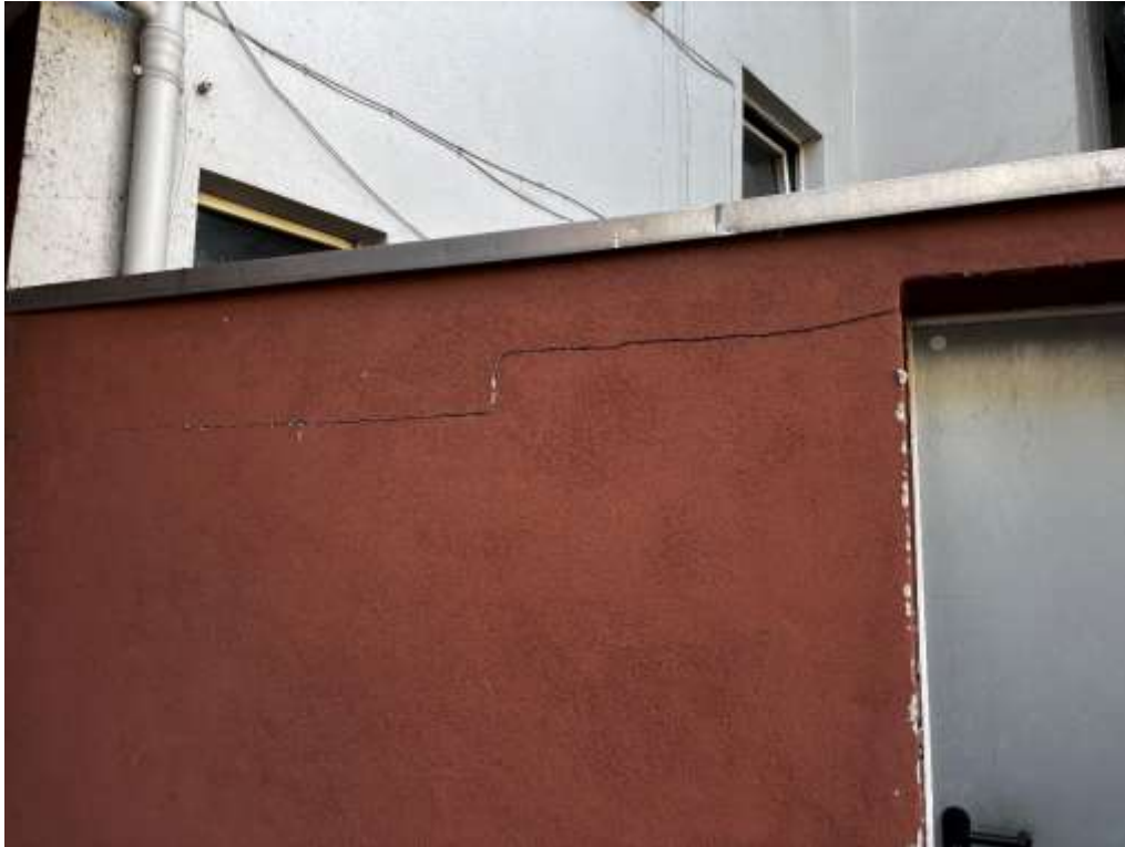
Rissbildung im hofseitigen Anbau
