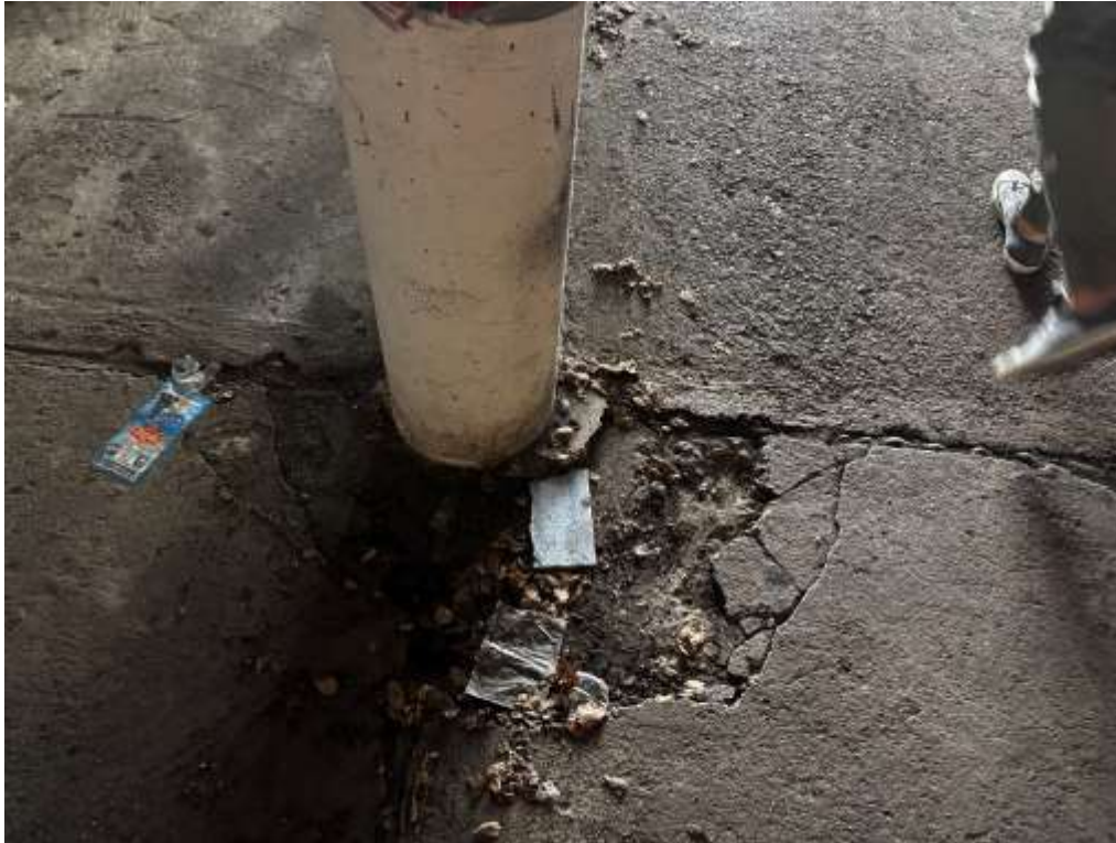
Estrichschäden im Bereich der Stützen
