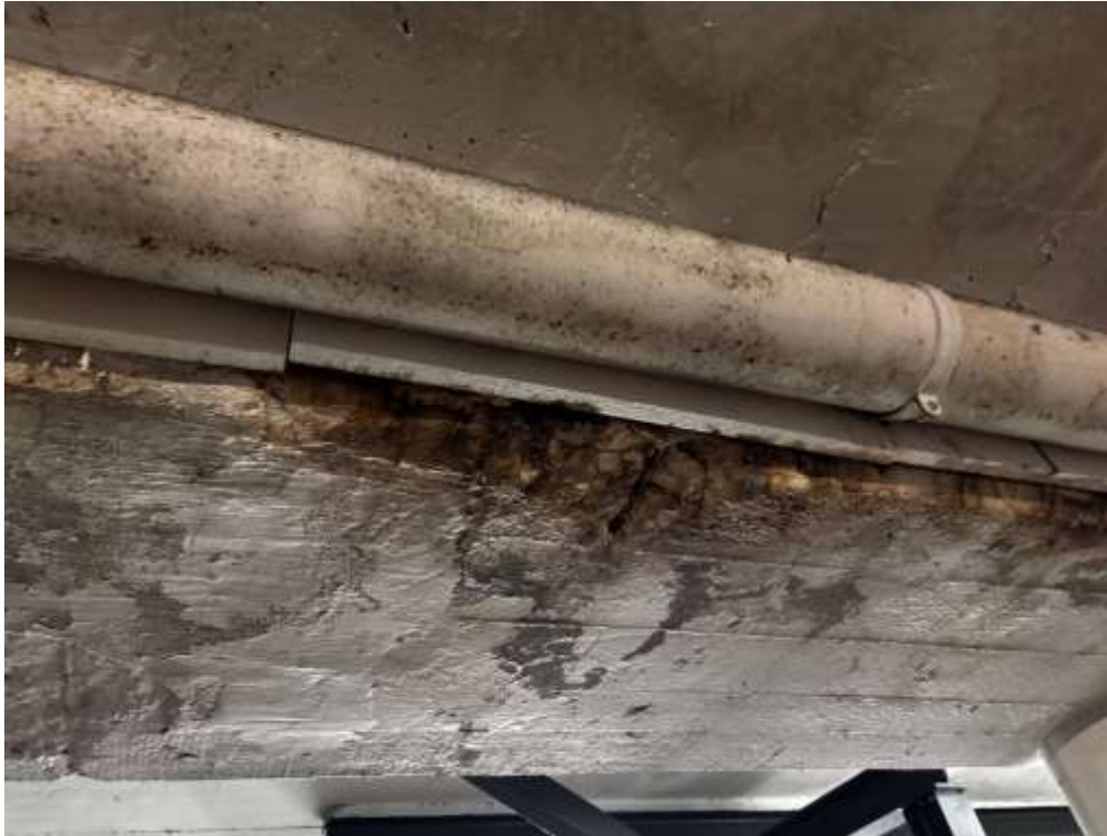
Korrosionsschaden an einem Unterzug
