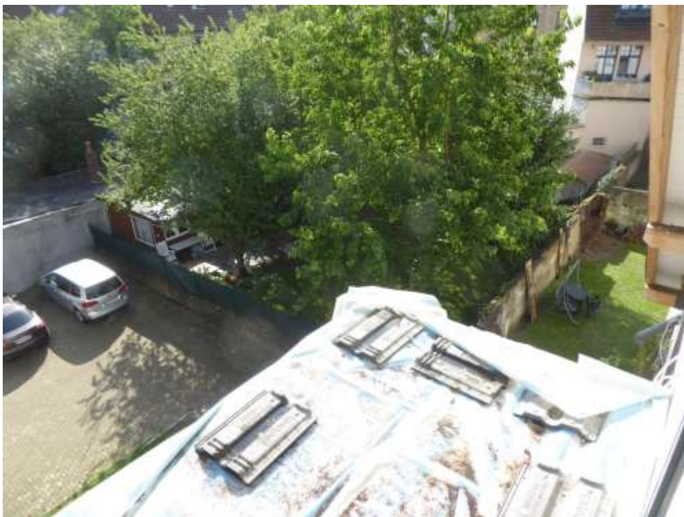
Balkon 2. OG: fehlende Abdichtung
