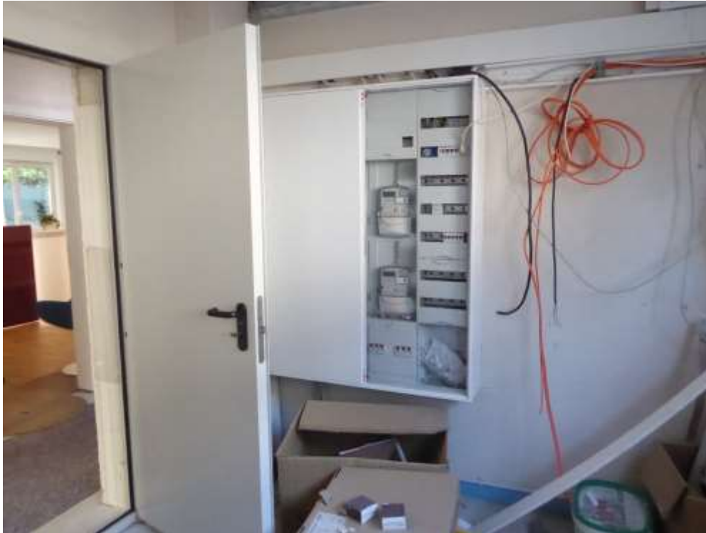
Elektroinstallation nicht fertiggestellt
