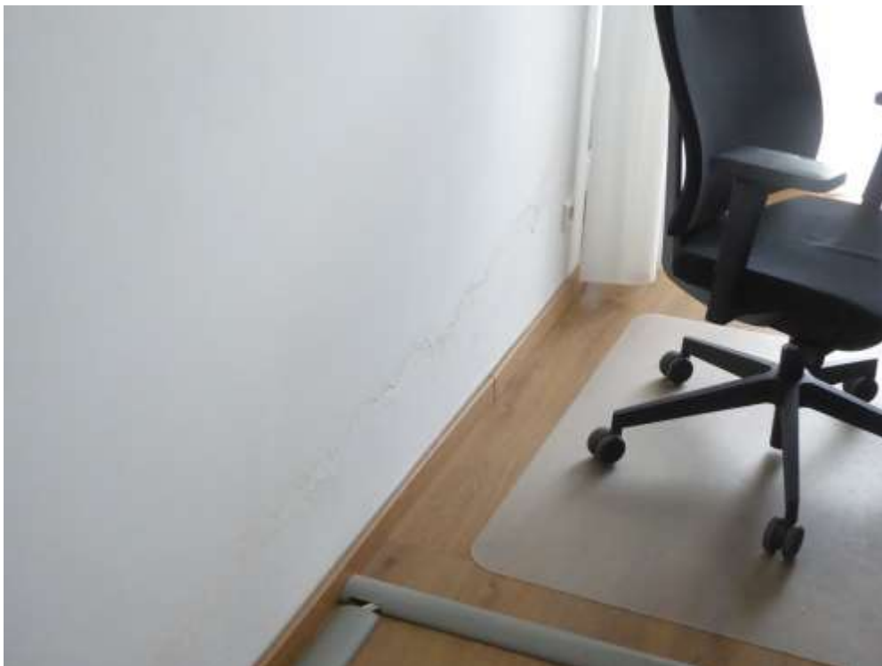
EG: aufsteigende Feuchtigkeit im unteren Wandbereich
