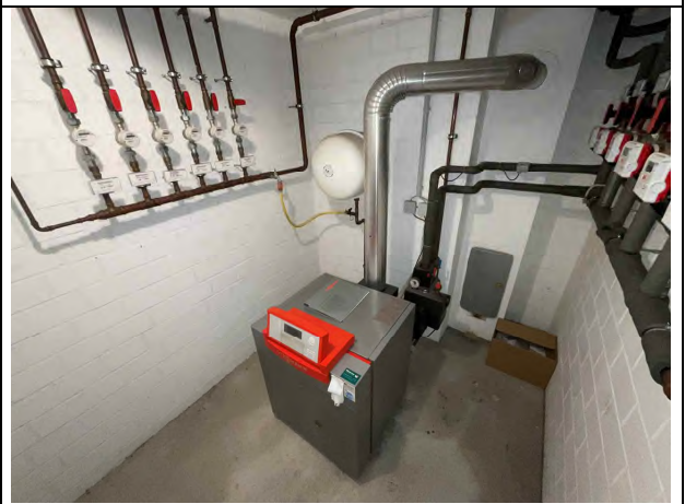
Foto 10: Heizung im KG
