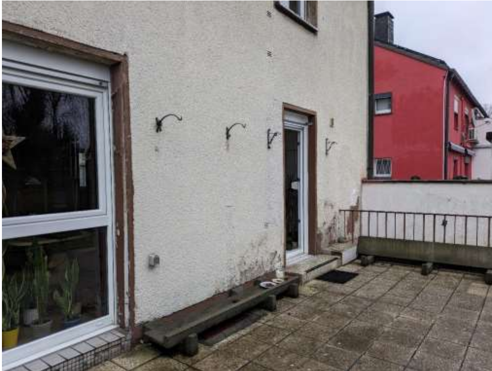
Schäden am Außenputz
