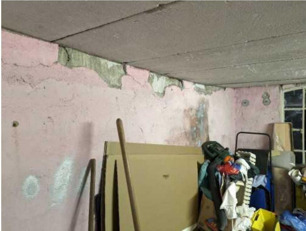
Garage, Schäden am Innenputz
