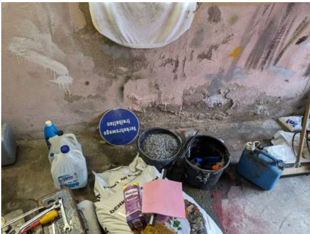
Garage, aufsteigende Feuchtigkeit
