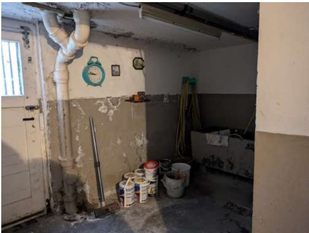
Ausblühungen an einer Kellerwand
