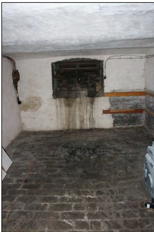
Foto Nr. 24: Kellergeschoss, Abstellraum / Stromhausanschluss
