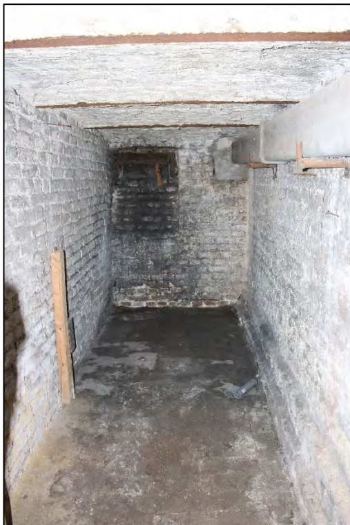
Foto Nr. 22: Kellergeschoss, Abstellraum
