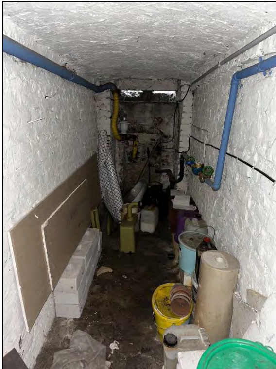
Foto Nr. 25: Kellergeschoss, Hausanschlussraum
