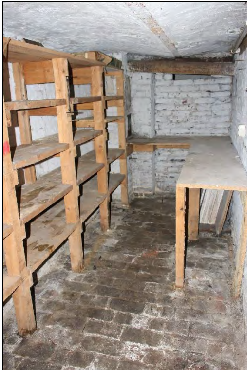
Foto Nr. 23: Kellergeschoss, Abstellraum
