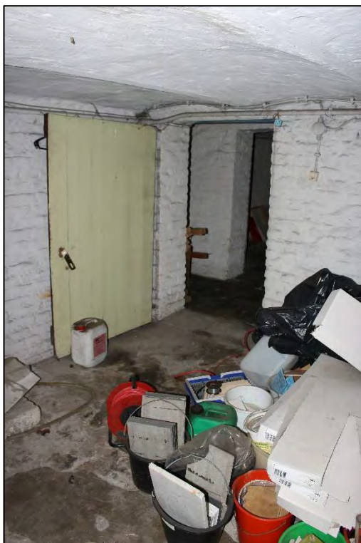
Foto Nr. 20: Kellergeschoss, Abstellraum
