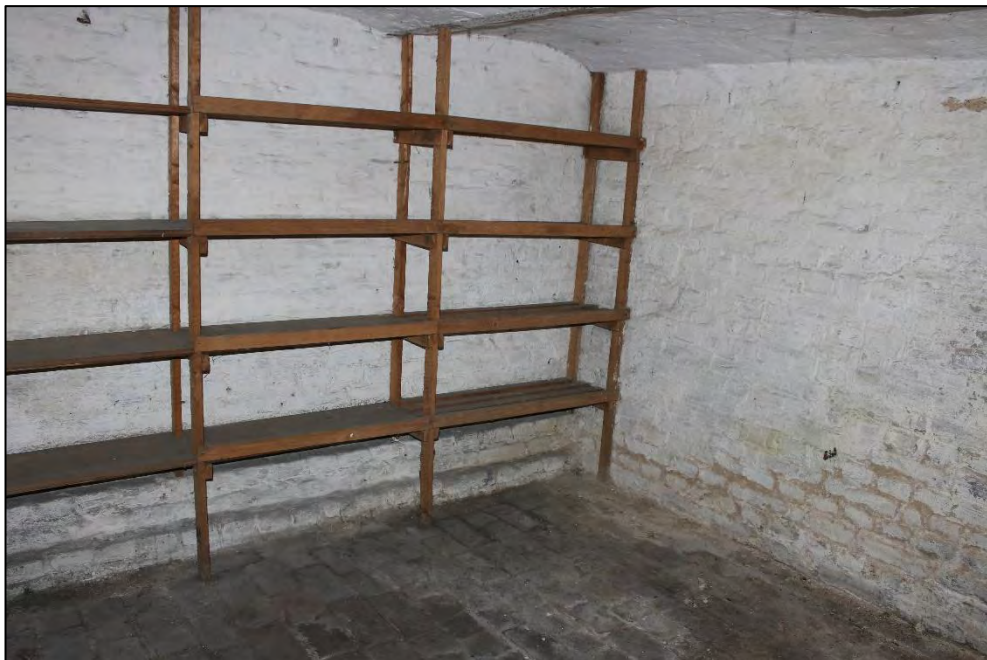
Foto Nr. 18: Kellergeschoss, Abstellraum
