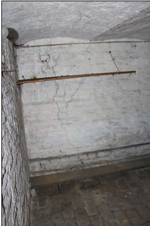
Foto Nr. 19: Kellergeschoss, Abstellraum
