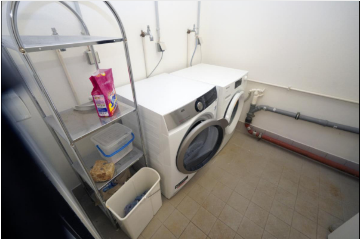
Waschmaschinenraum Nr. 1U08.2
