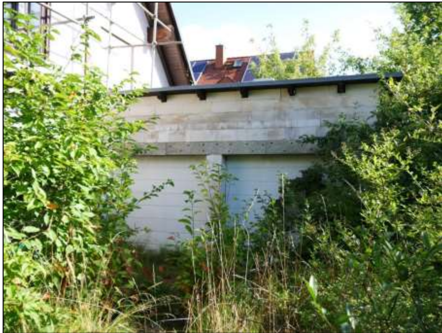
vor der straßenseitigen Giebelseite des Einfamilienhauses belegener Doppelgaragen-Anbau mit durch dschungelartiger Spontanvegetation dicht zugewachsener Zufahrt aus dem linken Bauwich
