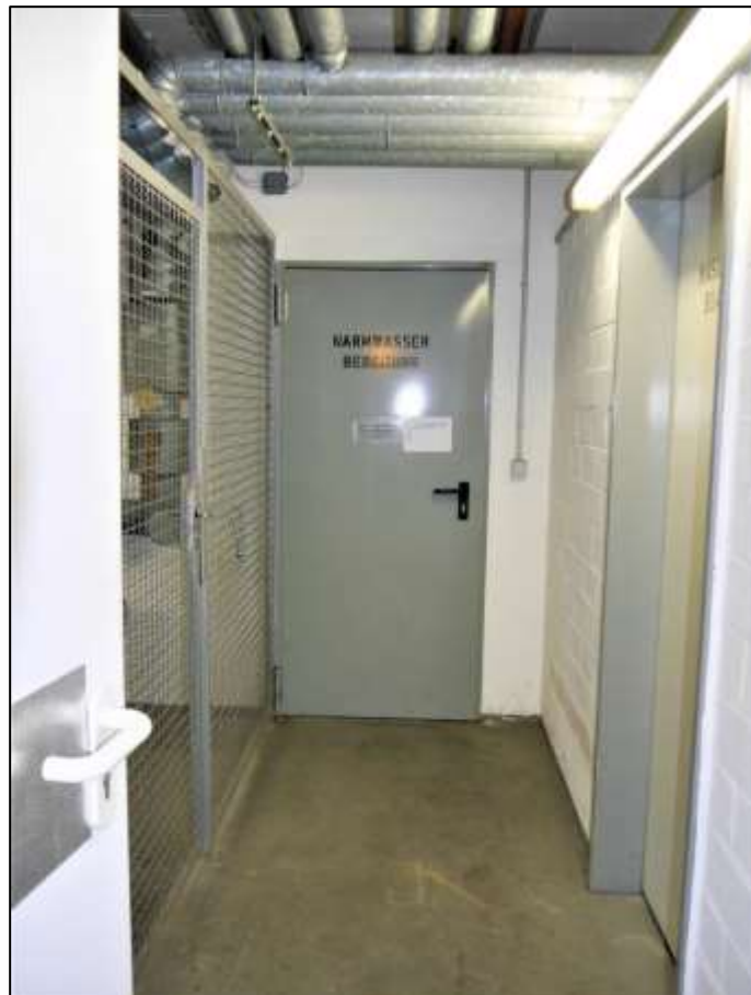
nominelles Untergeschoss im ebenerdig zugänglichen Eingangsgeschoss mit an den Zentralflur im rechten Gebäudeteil des Hauses Nr. 25 anbindenden haustechnischen Räumen
