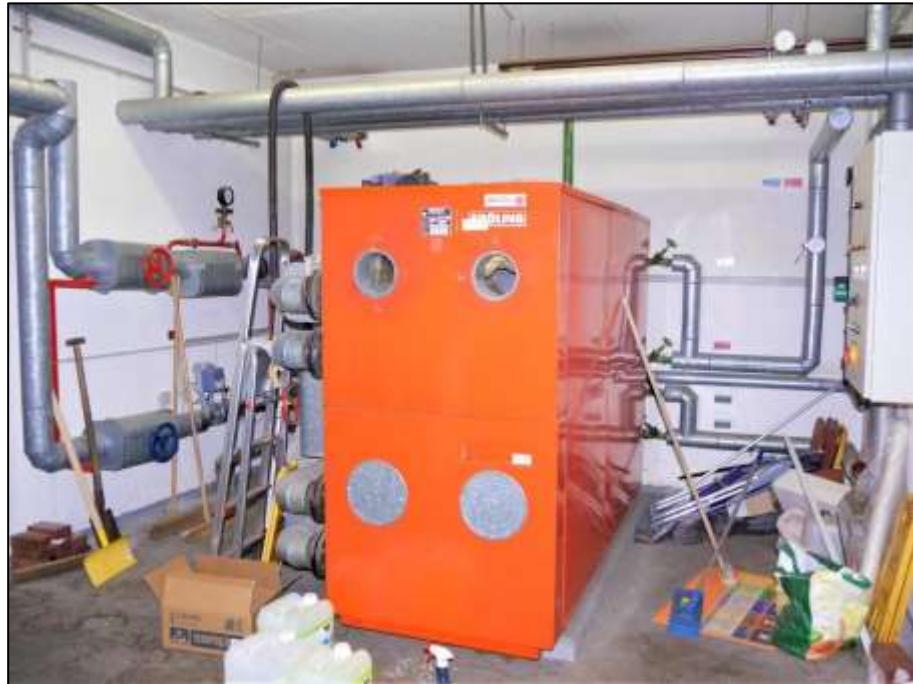
Warmwasserbereiter der Fernwärmeversorgung im sogen. Untergeschoss
