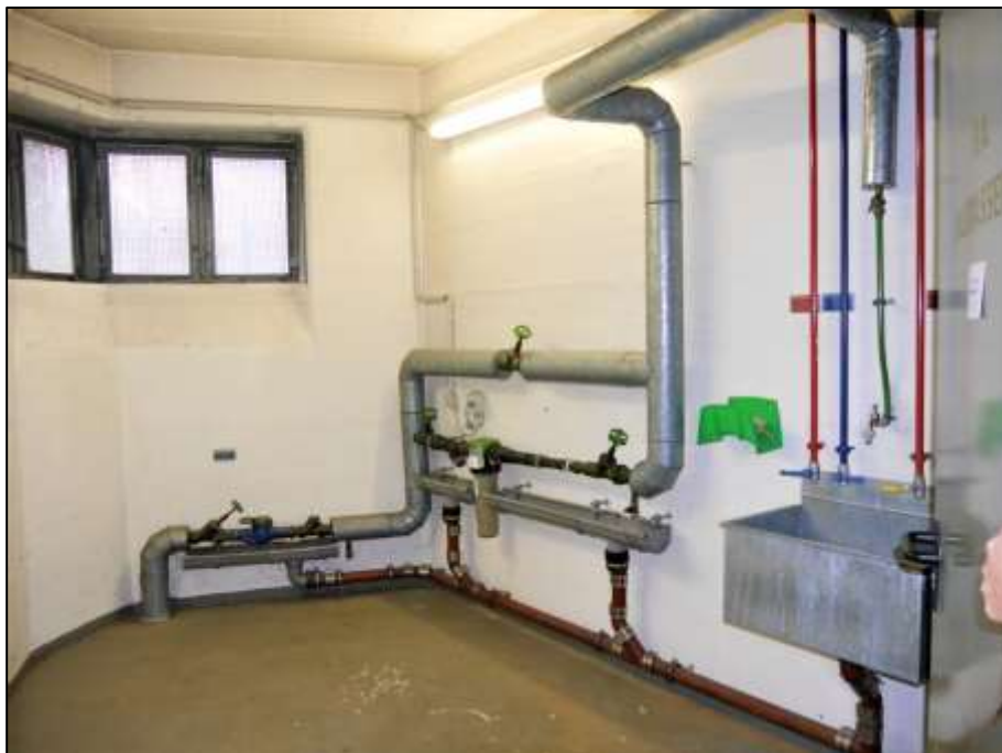
Hausanschlussraum mit Frischwasserfilter und Zählereinheit etc. sowie großem Ausguss mit verschiedenen Zapfventilen
