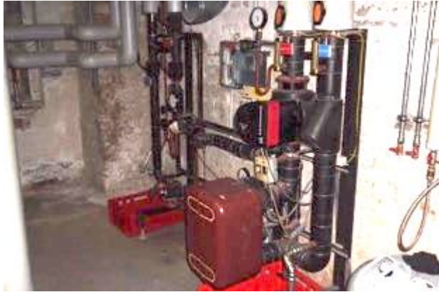
Heizungsraum, Übertragung Fernwärme
