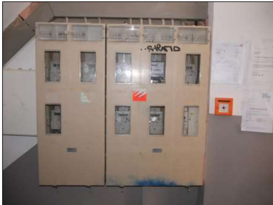
Stromzählerkasten im Hauseingangsbereich des Quergebäudes
