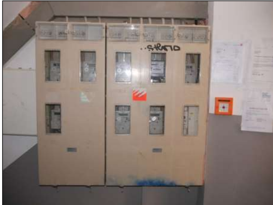
Stromzählerkasten im Hauseingangsbereich des Quergebäudes
