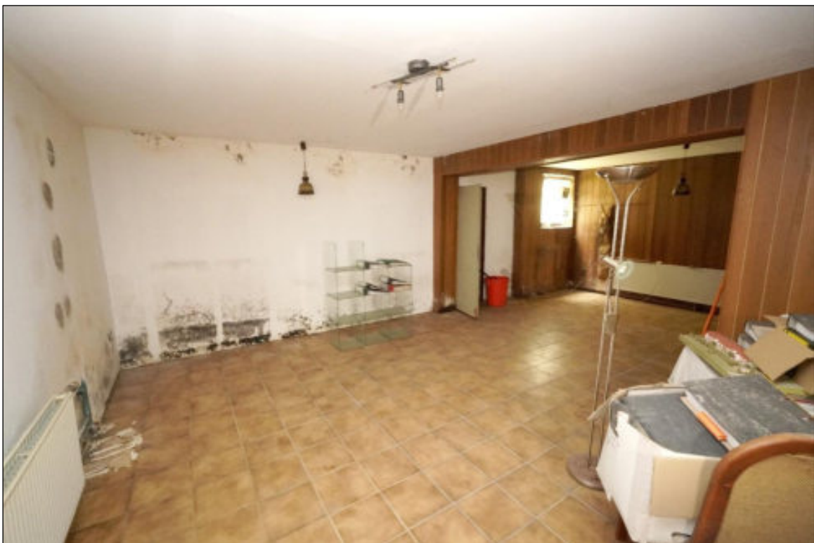
Kellergeschoss, Vorraum zur Kegelbahn, Rückwand mit Schimmelbildung
