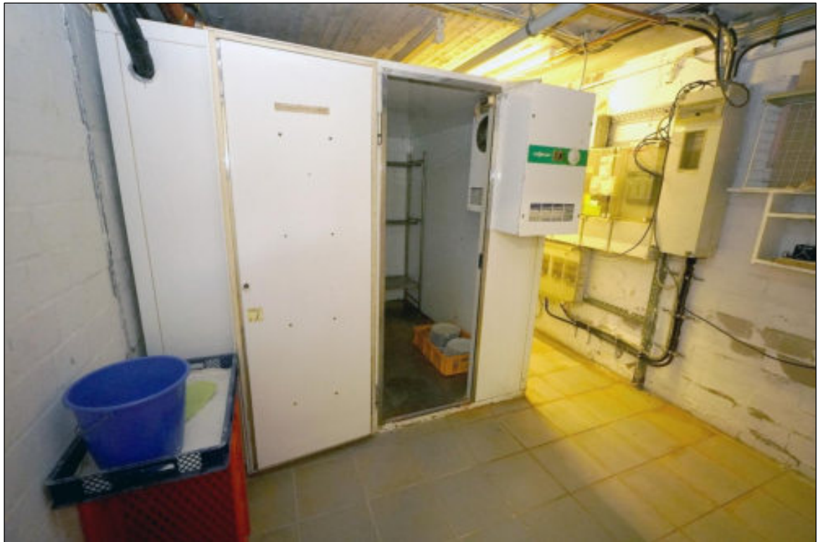
Kellergeschoss, Kühlzelle / Bierkeller
