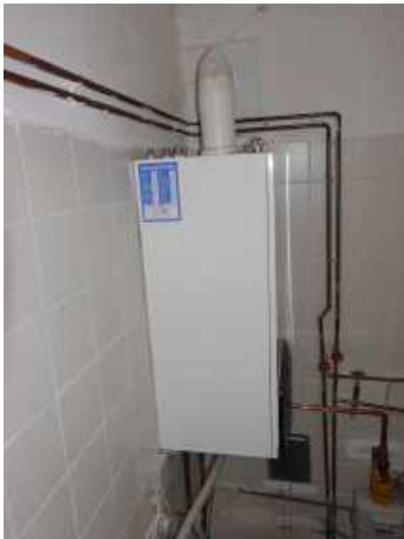
Gastherme für die Heizung
