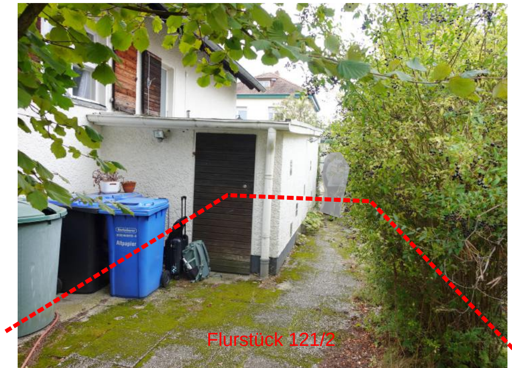
Flurstück 121/2 (Verkehrsfläche), Blick Richtung Straße, Überbau durch die Garage
