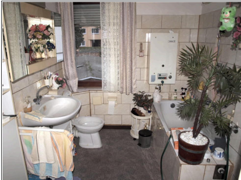
Abbildung 15: Badezimmer der WE im Obergeschoss
