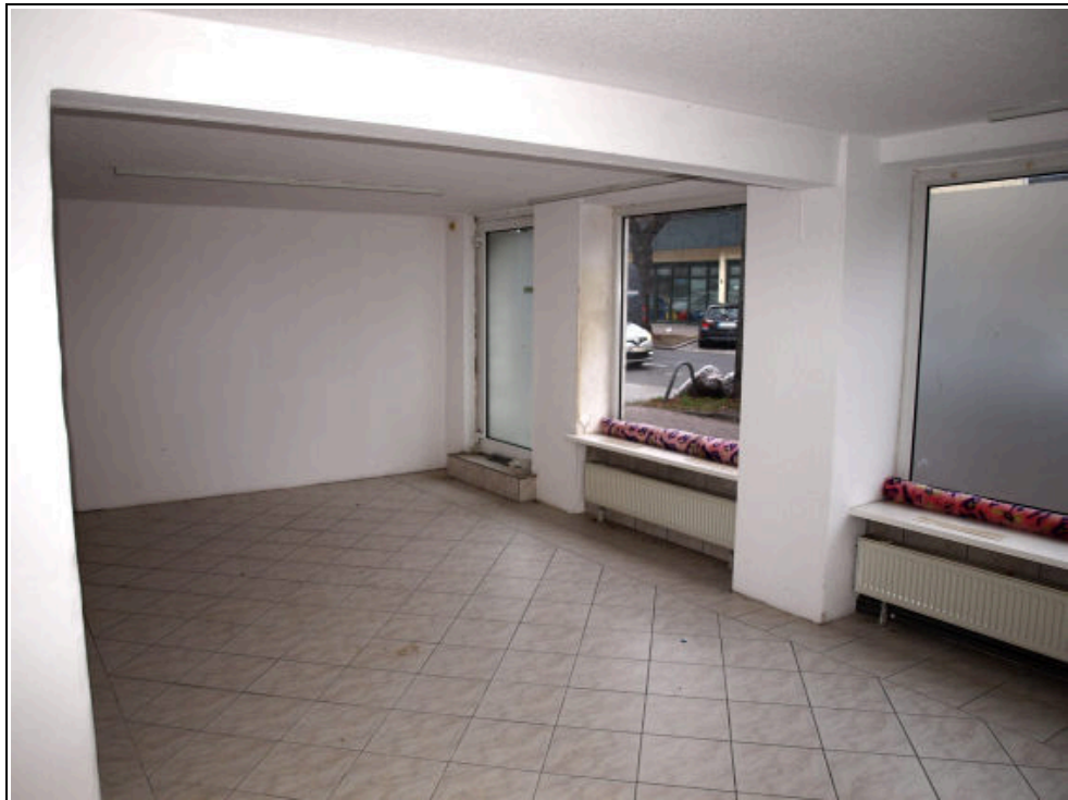
Abbildung 13: ehemaliges Ladengeschäft, niedrige Deckenhöhe, Leerstand ca. 10 Jahre
