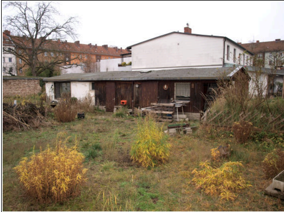
Abbildung 11: ruinöses Nebengebäude, frühere Nutzung als Sattlerei
