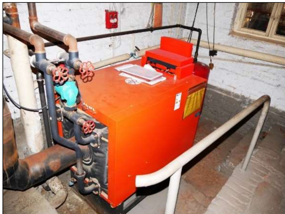
eingesenkte Kessel-Standfläche vor dem unterkellerten Wintergarten- bzw. Veranda-Anbau mit Ölheizkessel vermtl. aus dem Jahre 1989
