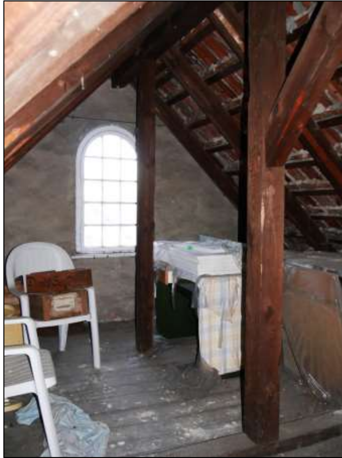
Rohdachboden mit stehendem Fenster nebst Bogensturz im straßenseitigen Frontspieß hinter einem sogenannten Zwerchhaus im Dachraum
