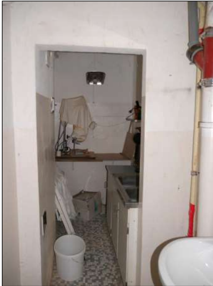
Blick aus dem Vorraum als Durchgangsraum mit Porzellan-Waschtisch in die innenliegende Teeküche als gefangener Raum mit Doppelpüle im Kellergeschoss
