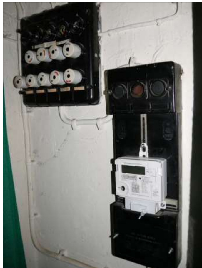
Sicherungstafel mit alten Sicherungsautomaten und modernem elektronischem Wechselstromzähler in der Kellerdiele vor der Zugangstür des Hausanschlussraums
