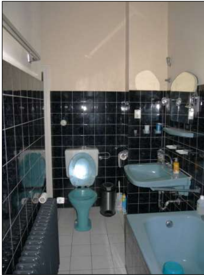
aus dem Flur vor dem eingestauten Keller-treppenabgang zugängliches Badezimmer im Hochparterre vor der Gebäuderückseite
