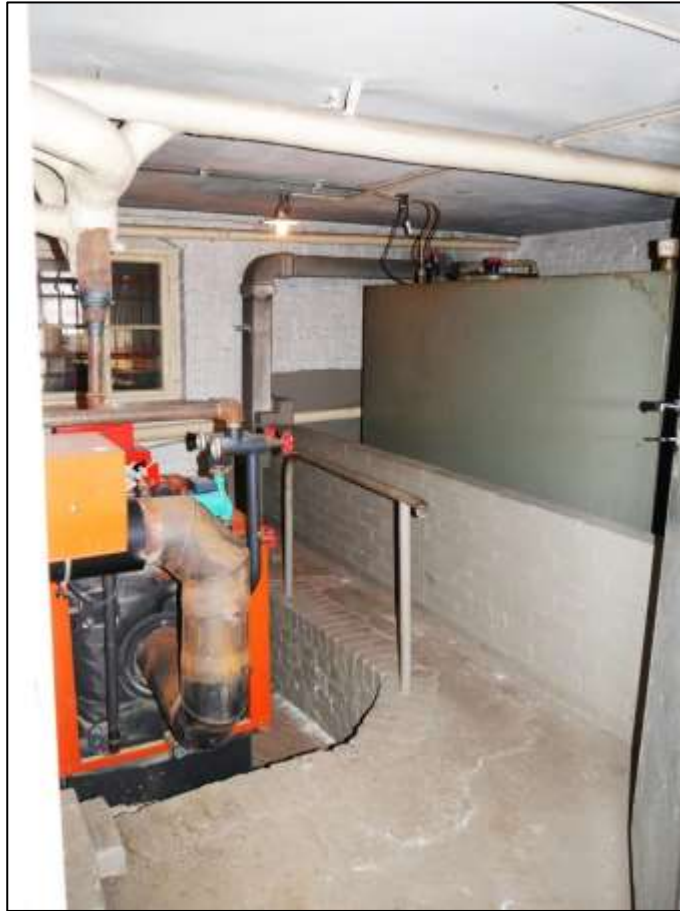
Heizungskeller mit eingesenkter Kessel-Standfläche vor dem unterkellerten Wintergarten- bzw. Veranda-Anbau u.a. mit Öl-Auslaufwanne und kellerschweißtem 5000-L-Stahl-tank aus dem Jahre 1964
