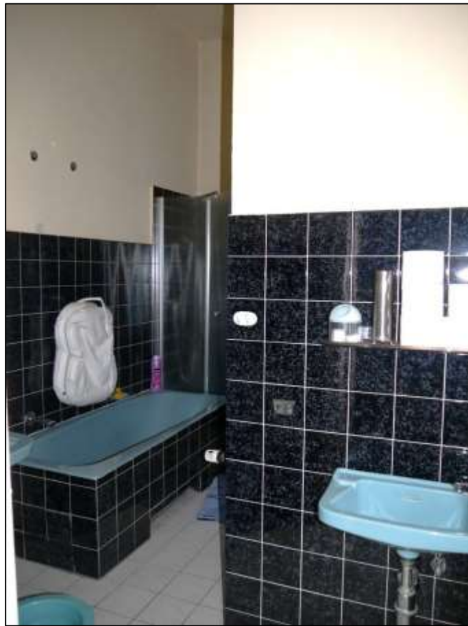
aus dem Flur vor dem eingehausten Kellertreppenabgang zugängliches Badezimmer im Hochparterre vor der Gebäuderückseite
