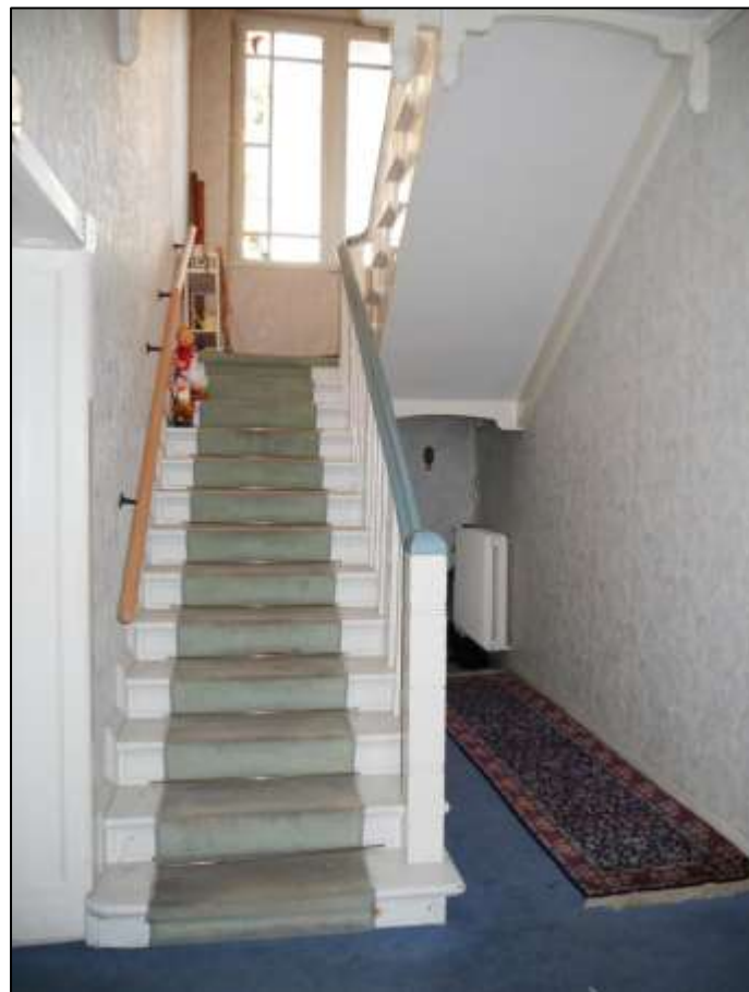
Treppenaufgang aus dem Hochparterre in das Obergeschoss mit gegenläufiger Treppe nebst Zwischengeschosspodest vor der gartenseitigen Außenfront des Gebäudes
