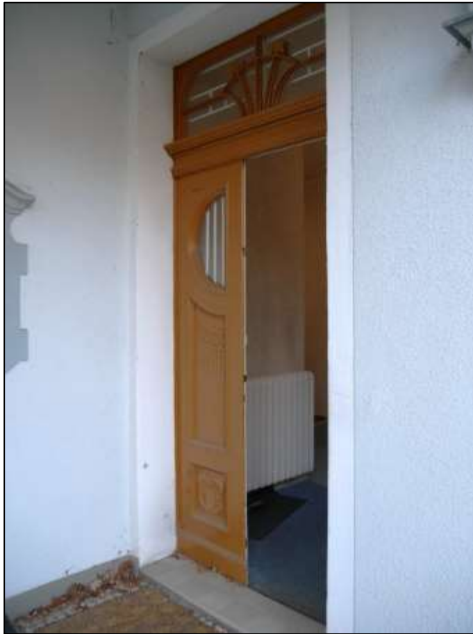
Blick aus dem gedeckten 1-geschossigen Hauseingangsbereich auf die Hauseingangstür des Wohngebäudes mit anbindendem Flur im Hochparterre
