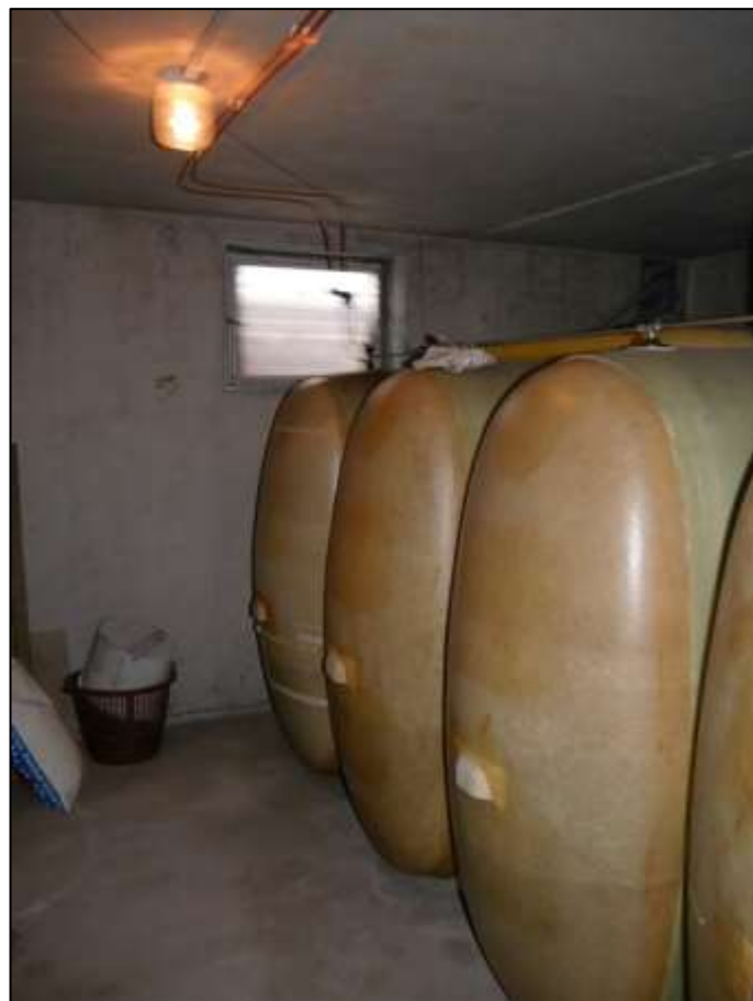
Öltanklager- raum mit Kunststoff-Batterie- tanks á 2.000 L Volumen im postalisch rechts span- nenden Keller- flur vor der zur Fontanestraße orientierten Hauseingangs- front bzw. der zum rechten Bauwich orien- tierten Gebäu- defront
