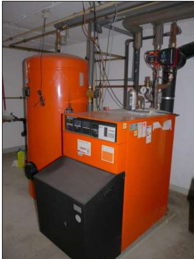
Heizungskeller mit Öl-Heizkessel im postalisch rechts spannenden Kellerflur vor der zur Fontanestraße orientierten Hauseingangsfront
