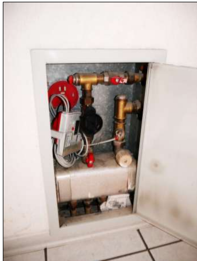
Heizleitungsverteilung der Unterflurverteilung in einer Wandnische in der Eingangsdiele mit Revisionsklappe
