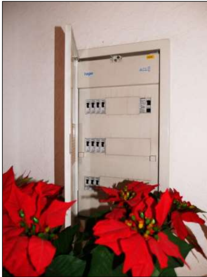
Sicherungskasten der Wohnung in der Eingangsdiele
