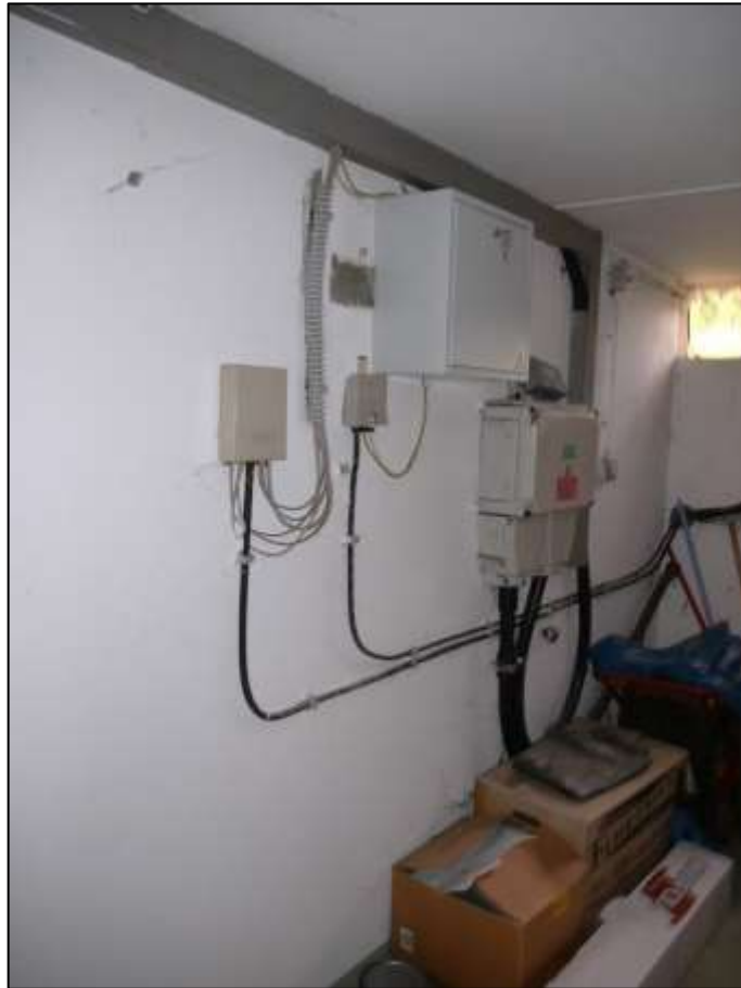
Hausanschlüsse im Bereich des Heizungskellers
