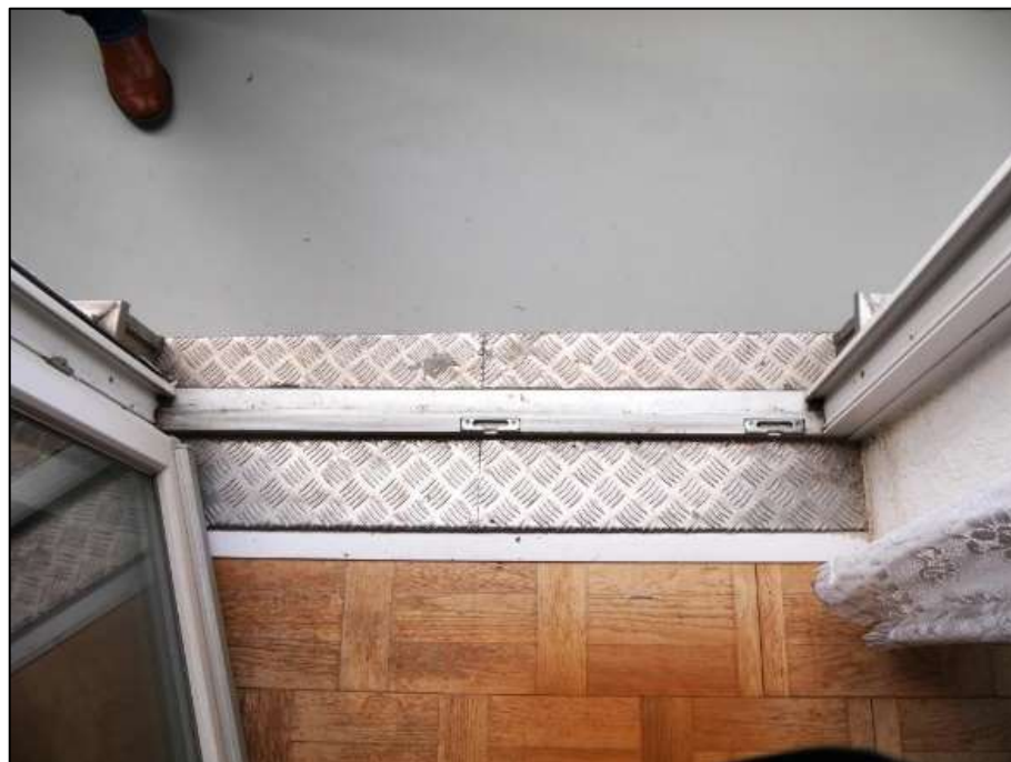
extrem niedrige Türschwelle vor dem Wohnzimmer zu dem anbindenden Balkon des Wohnungseigentums
