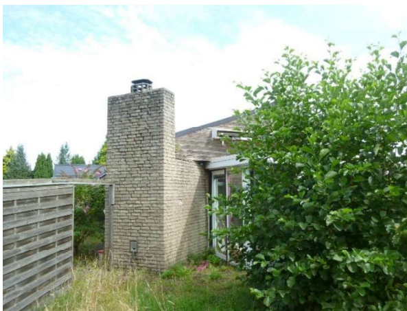
Ansicht des Außenschornsteins
